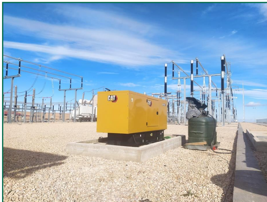
Fotografía 6. Generador en el interior de a subestación, sobre plataforma construida y bidón de gasoil sobre bandeja.
