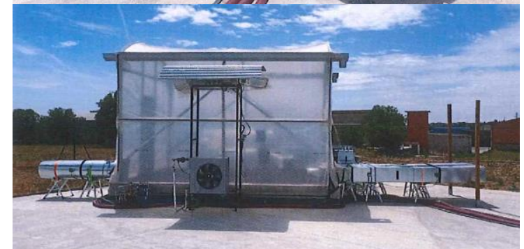
Invernadero con conductos extractores de ventilación al frente y dispositivo de oxidación avanzada en la parte superior izquierda
