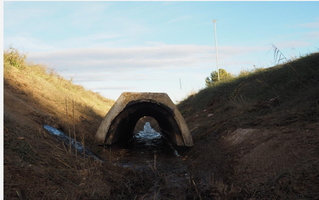
Fotografía 6 : Desagüe en san Juan con canaleta de caudal elevado
