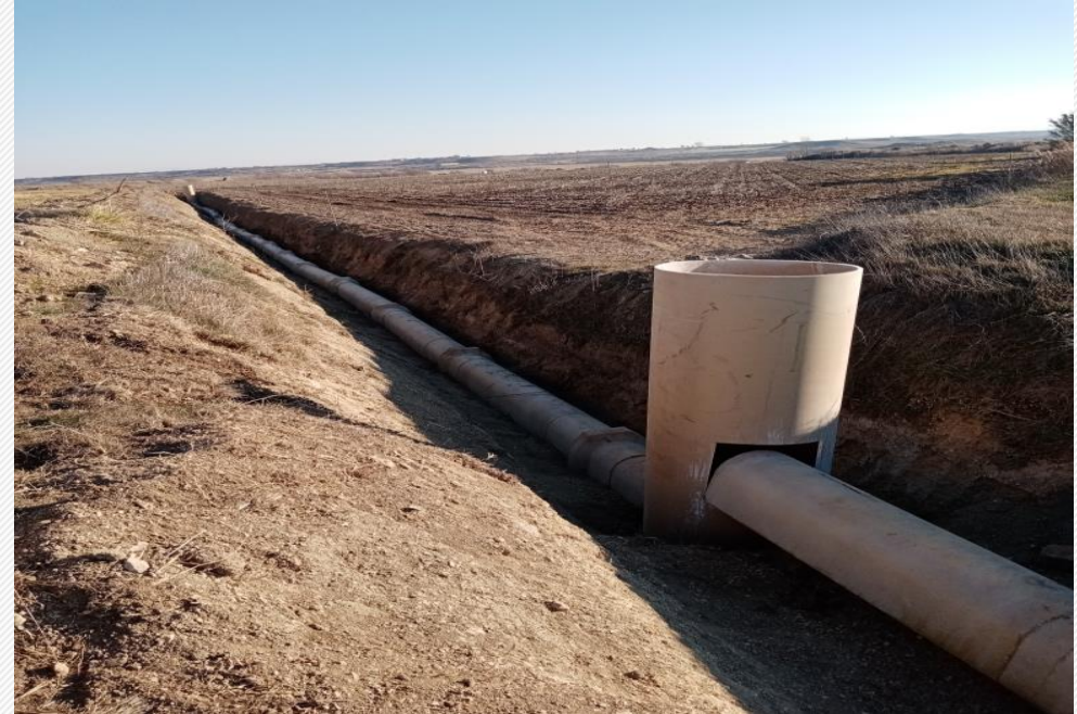
Fotografía 8 : Desagüe en Orillena canaletas mas arqueta con salto de PRFV
