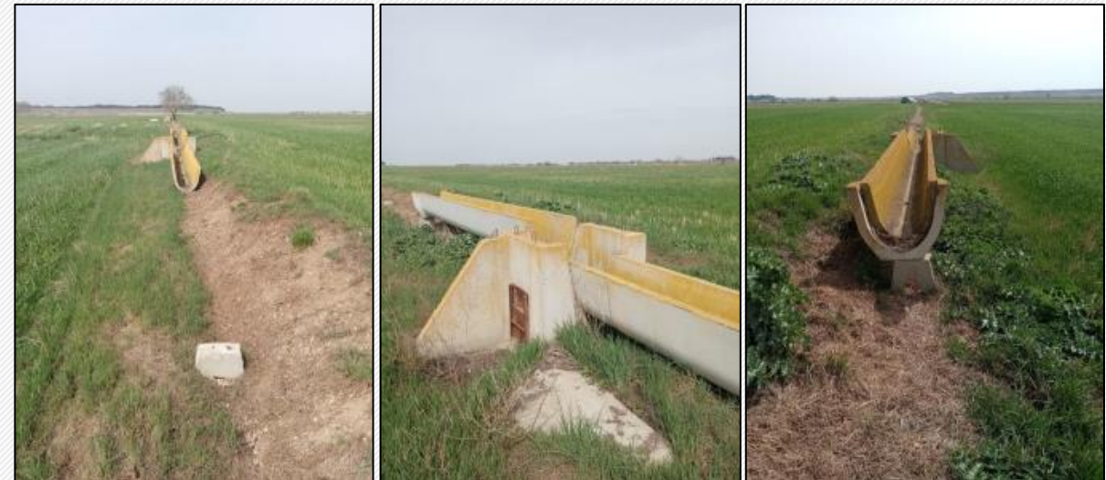
Foto 6. Canaletas y tomas en desuso en fase de extracción para las pruebas piloto de machaqueo o de drenajes
