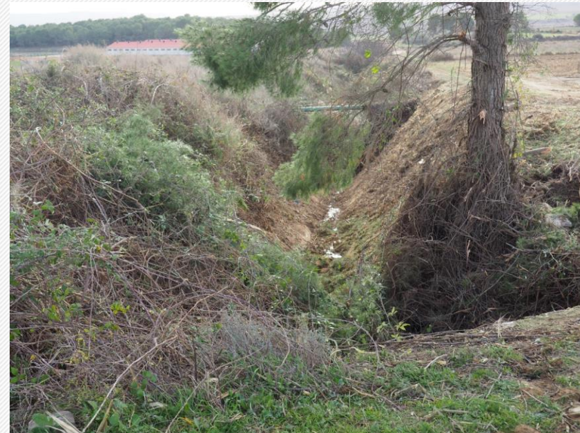
Fotografía 2: Desagüe en hormigón con mucha vegetación previa, caudal agua +20 l/sg.
