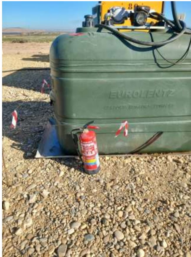
Figura 1: Medios de extinción de incendios junto a grupo electrógeno.
