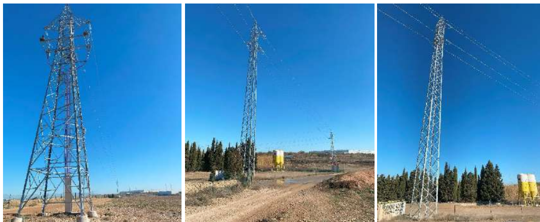
Foto nº4.: Estado general de los apoyos. Apoyo nº 1 y Apoyo nº 2 de la LAAT.
