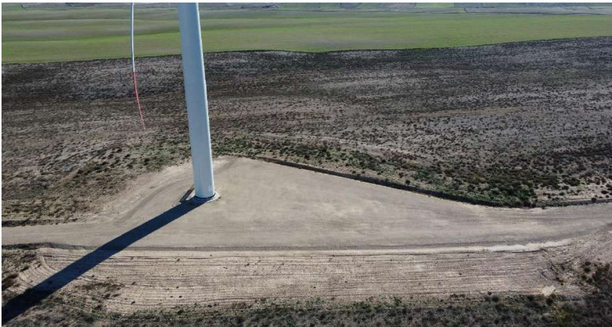
Foto nº2.: Plataforma del Aerogenerador REII-02.
