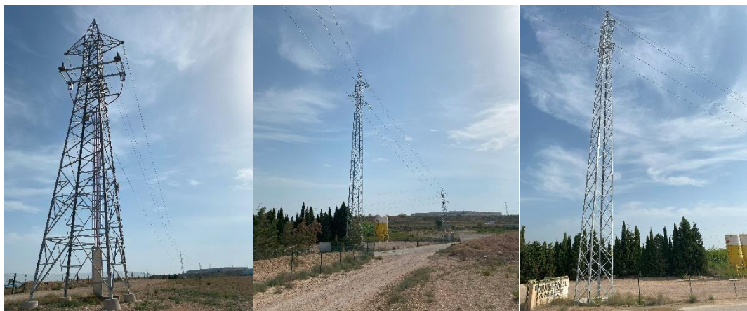
Foto nº5.: Estado general de los apoyos. Apoyo nº 1 y Apoyo nº 2 de la LAAT.
