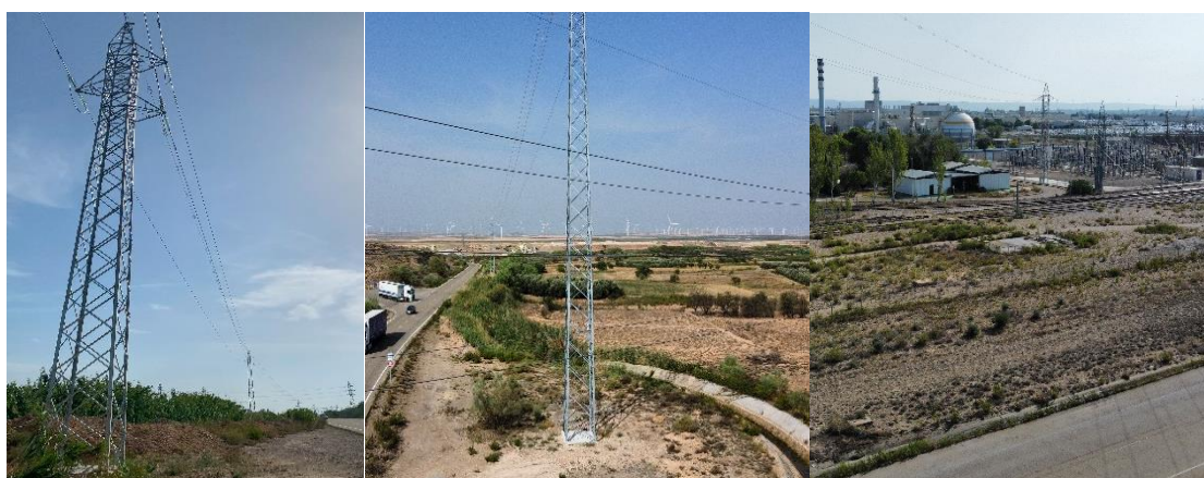
Foto nº7.: Estado general de los apoyos. Apoyo nº 5, Apoyo nº 6 y Apoyo nº 7 punto final de la LAAT.
