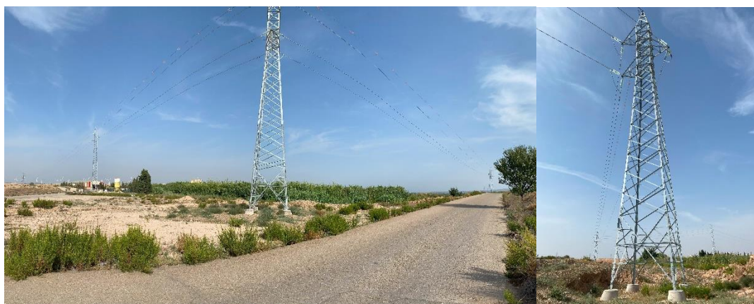
Foto nº6.: Estado general de los apoyos. Apoyo nº 3 y Apoyo nº 4 de la LAAT.
