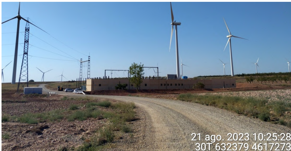
Figura 11: SET Los Visos, subestación eléctrica asociada al PE El Tollo.
