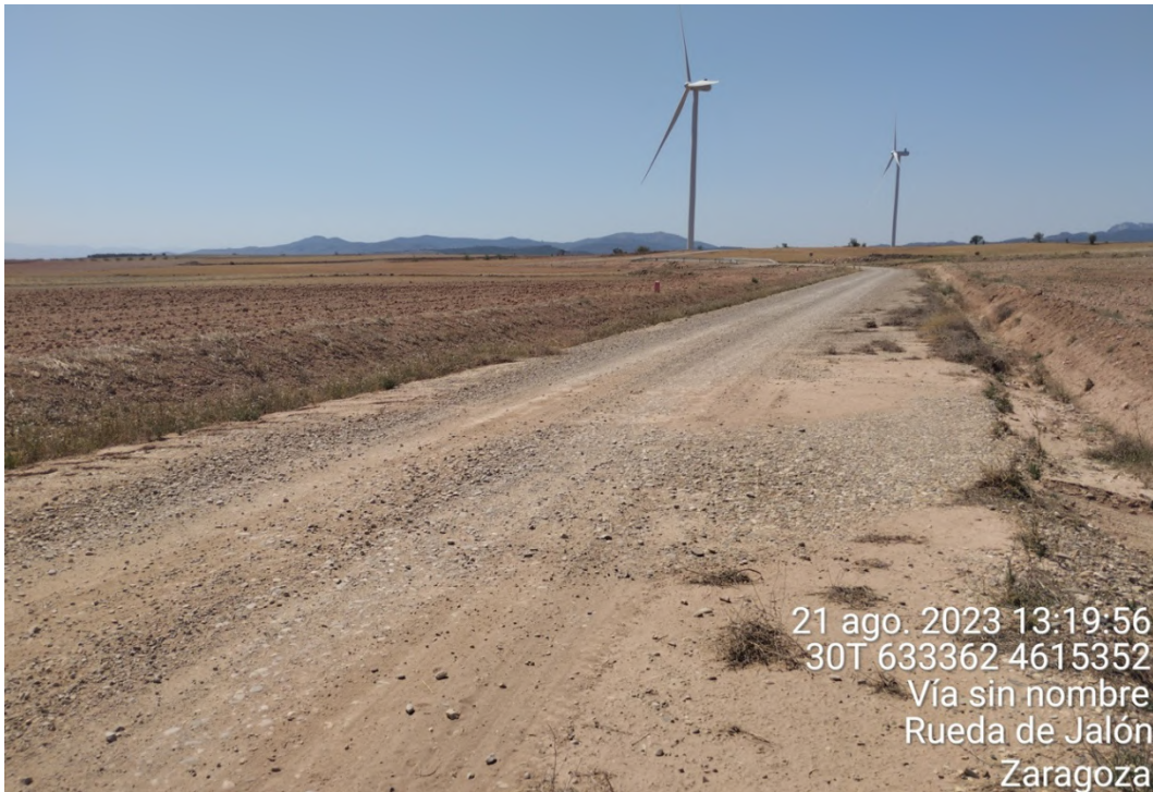
Figura 8: Estado de los viales de acceso aerogeneradores ET-1 y 2.
