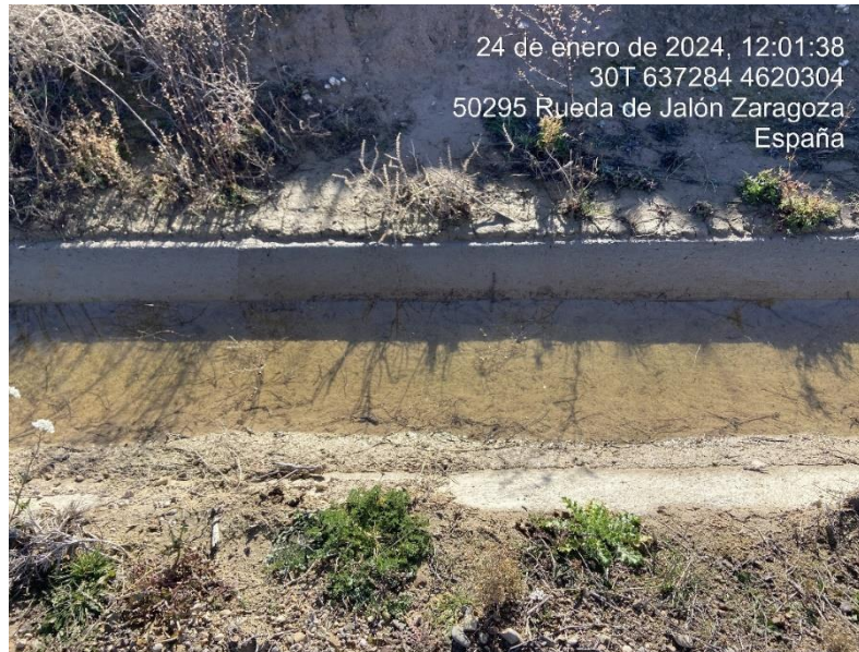
Figura 33: Canal de desagüe en la plataforma del aerogenerador ELL-11.
