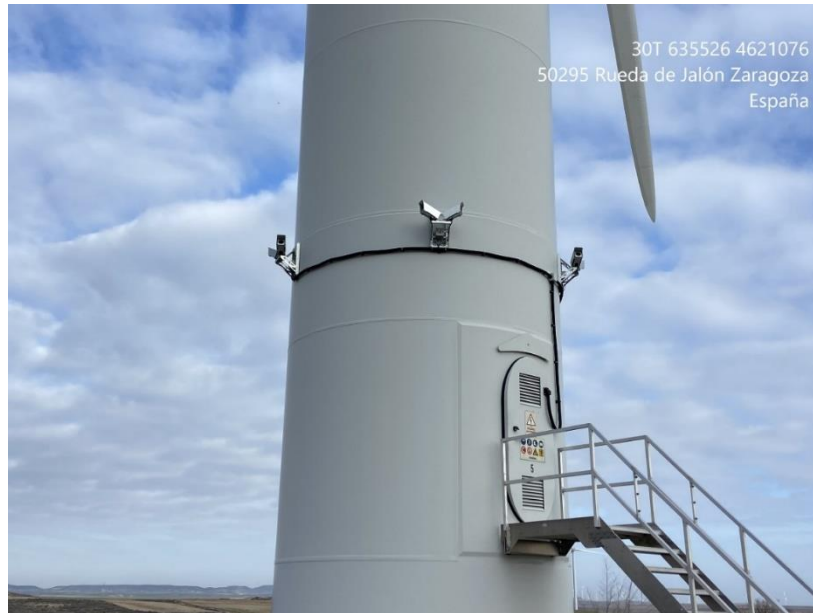
Figura 5: Sistema “3D Observer” instalado en 2023, ubicado en la torre del aerogenerador ELL-05.
