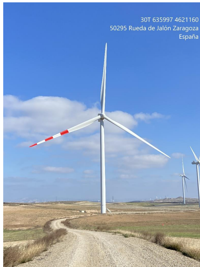
Figura 9: Foto del aerogenerador ELL-07 con la medida preventiva de pintado de palas.
