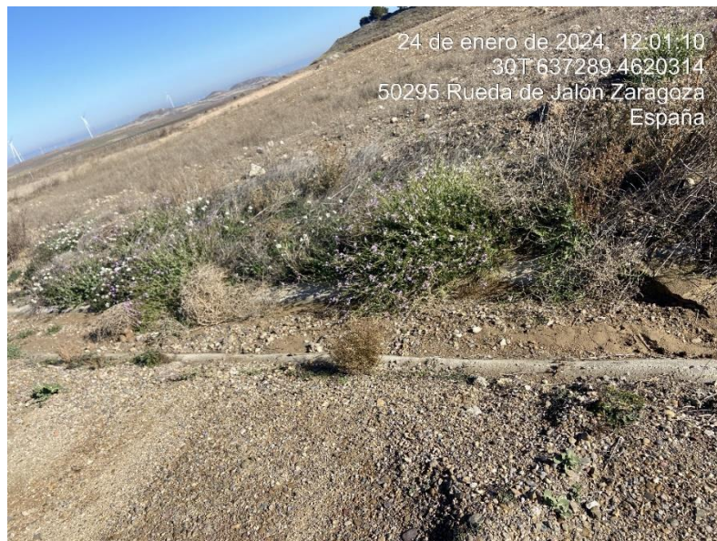
Figura 34: Canal de desagüe en la plataforma del aerogenerador ELL-10.
