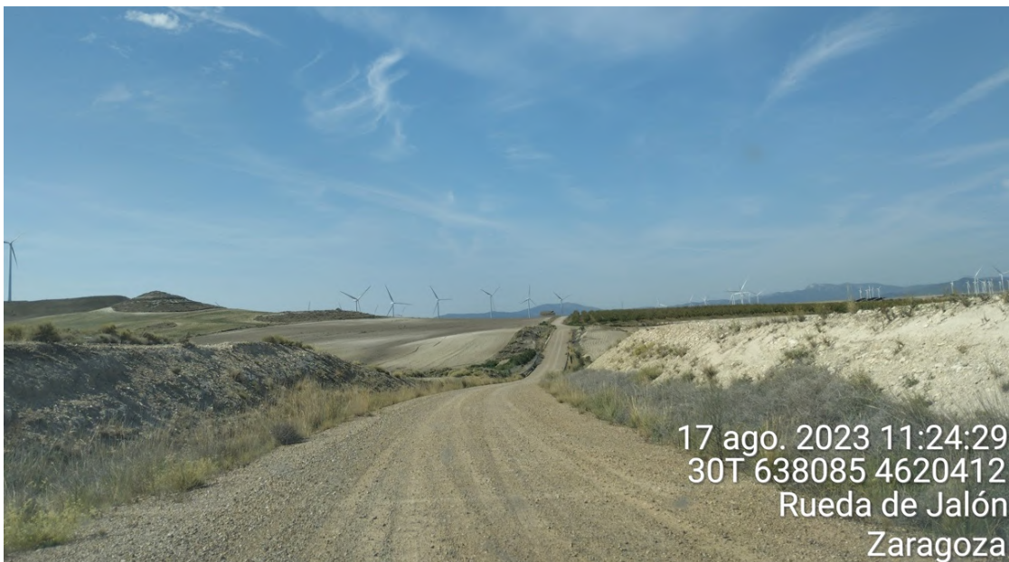
Figura 33: Vial y taludes de acceso a ELL-11 y 12 en correcto estado de conservación.
