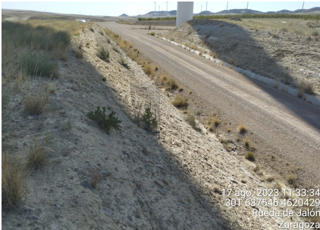
Figura 28: Plantaciones de waterbox en los taludes del vial entre ELL-10 y ELL-11, en correcto estado.
