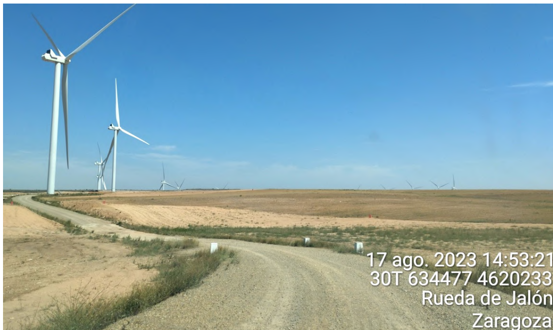
Figura 35: Badén de hormigón inundable en vial entre ELL-1 y ELL-2 en correcto estado.
