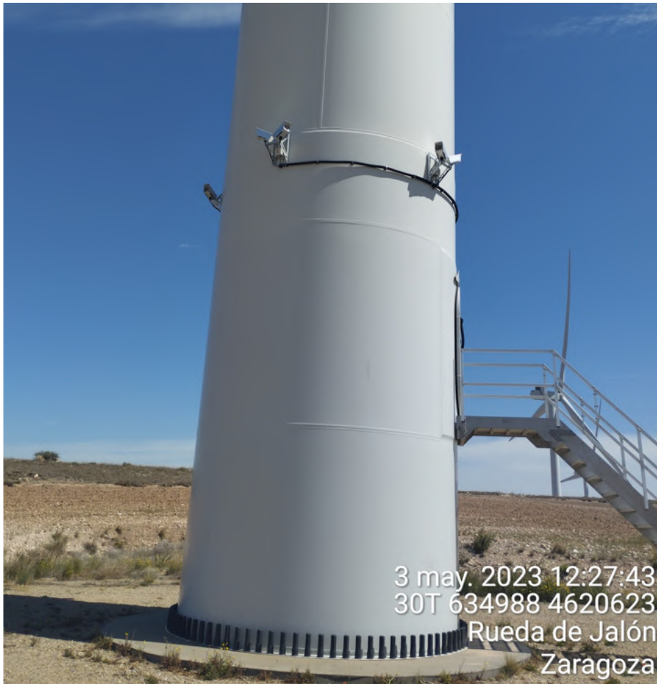
Figura 8: Uno de los nuevos Sistemas “3D Observer” instalados en 2023, en concreto el ubicado en la torre del aerogenerador ELL-3.
