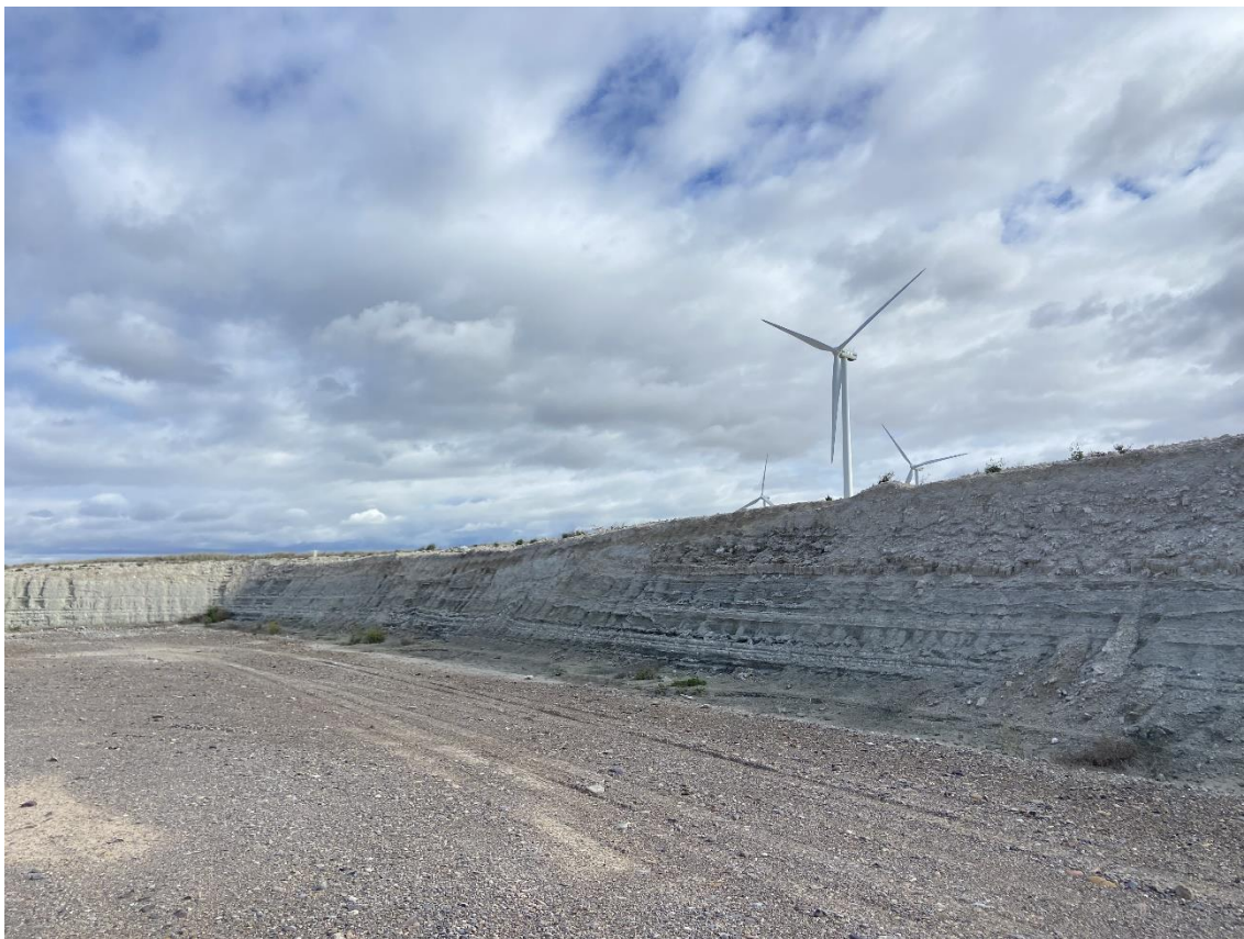
Figura 11: Fotografía de la erosión del talud al sur de la plataforma del aerogenerador CDM-02. Pueden observarse varias cárcavas provocadas por el agua de precipitaciones torrenciales.
