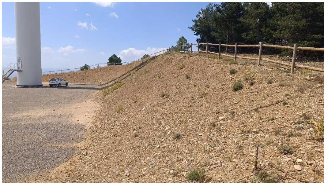
Figura 12. Aspecto de los taludes hacia el final del verano con las plantas sembradas con una apariencia agostada.
