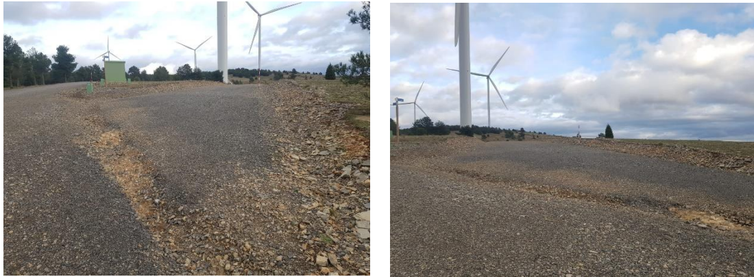
Figura 13. Riera formada en la entrada al vial de acceso al Aerogenerador APE-01 en el parque eólico “Ampliación Puerto Escandón”.
