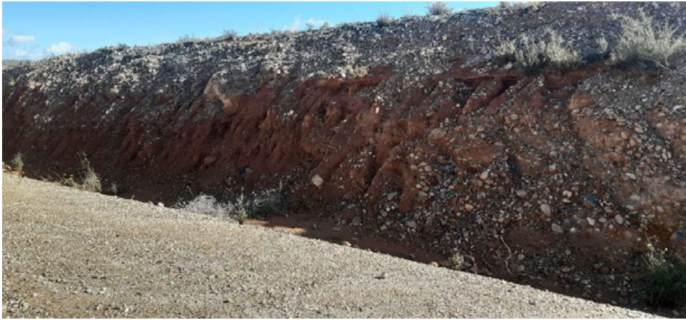
Fig. 3 Erosión hídrica en materiales lutíticos del talud de desmonte del vial de acceso al aero VR2.15.
