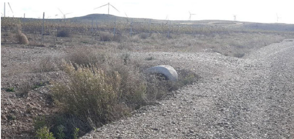
Fig. 2 Tubo de drenaje semitaponado con vegetación arbustiva en vial de acceso al aero VR2.04.
