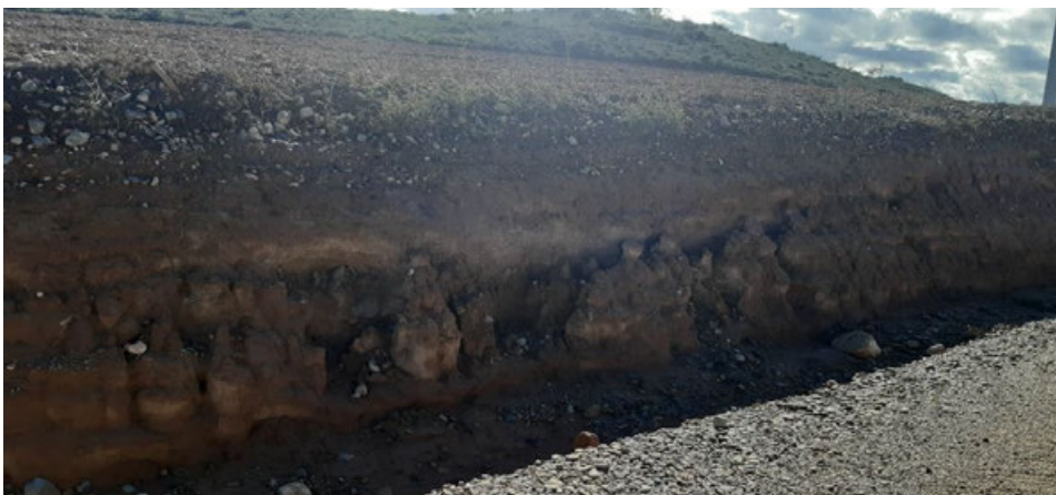
Fig. 1 Erosión hídrica en materiales lutíticos del talud de desmonte del vial de acceso al aereo VR2.14.
