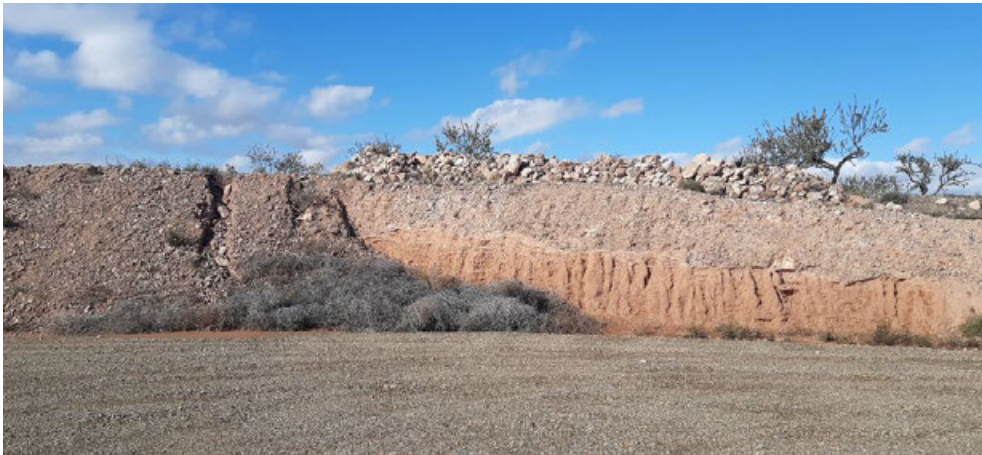
Fig. 4 Erosión hídrica en materiales lutíticos del talud de desmonte de plataforma del aero VR2.15
