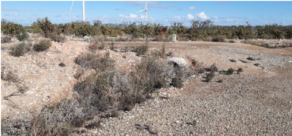
Fig. 1 Tubo de drenaje semitaponado con vegetación arbustiva en vial de acceso al aero VR2.11
