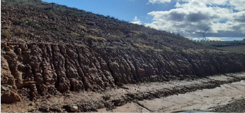
Fig. 2 Erosión hídrica en materiales lutíticos del talud de desmonte del vial de acceso al aero VR2.14.
