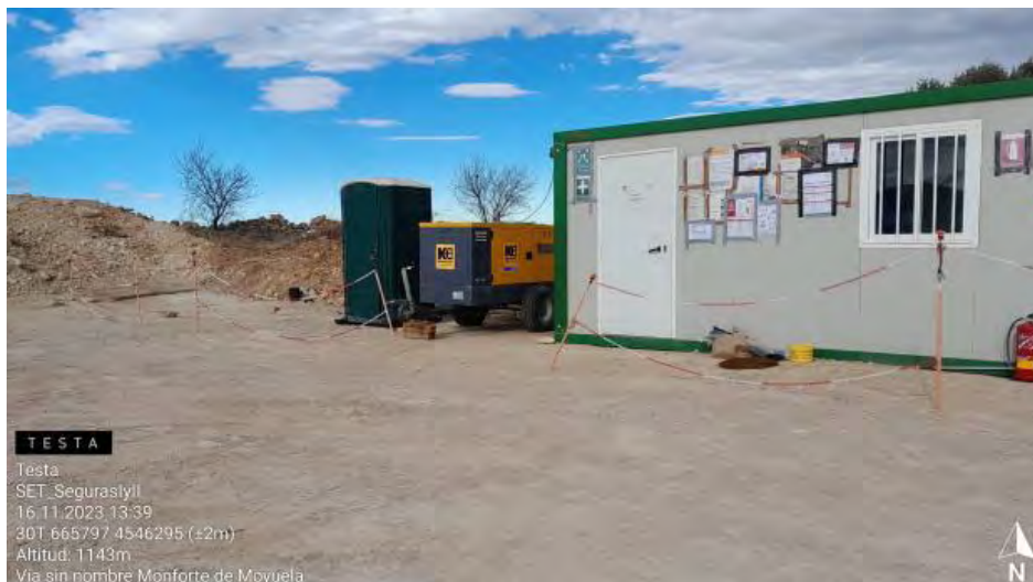
Generador sin protección de suelo .
