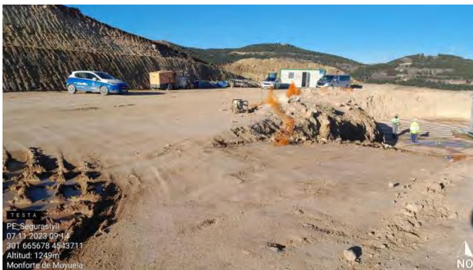
Generadores sin protección de suelo en SE2-4 .
