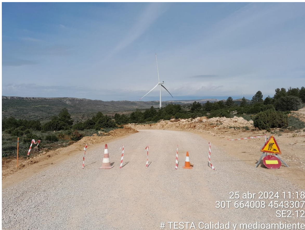
Imagen 2. Plataforma SE2-12 balizada por desprendimiento de material de los taludes
