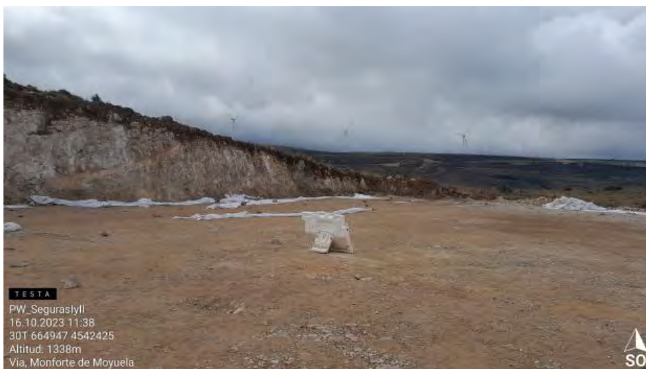
Plataforma en SE2-1
