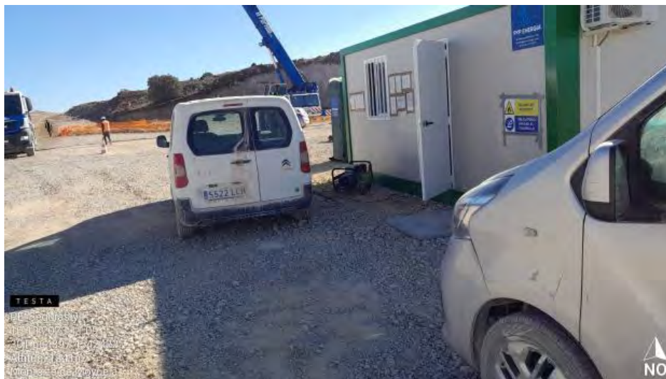
Generador sin protección de suelo en SE2-1
