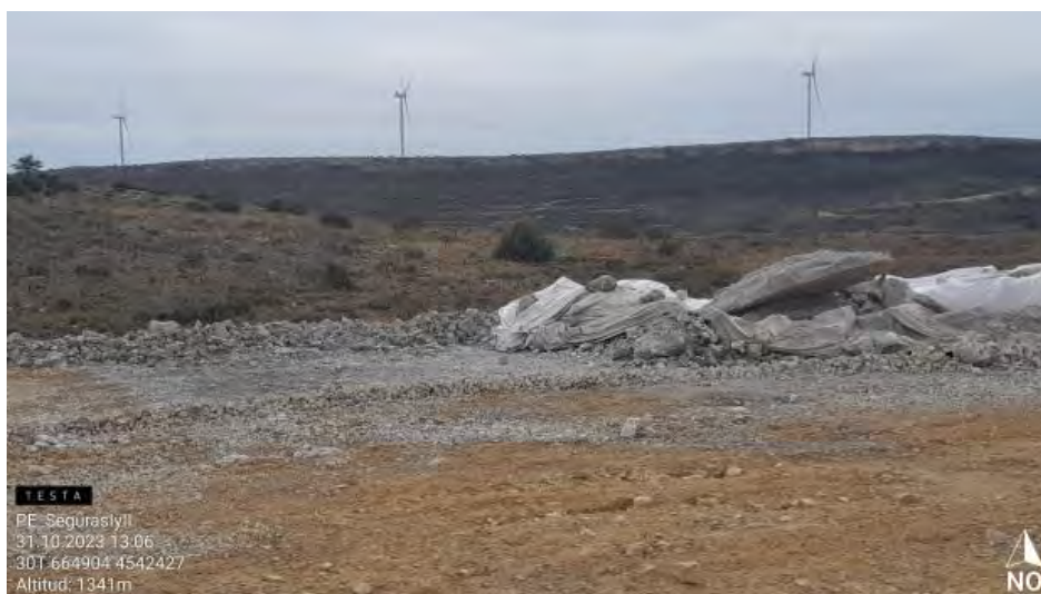
Pozo de lavado en SE2-1
