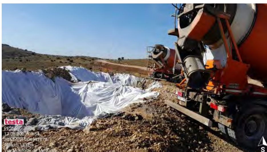
Limpieza de cubas en SE2-2
