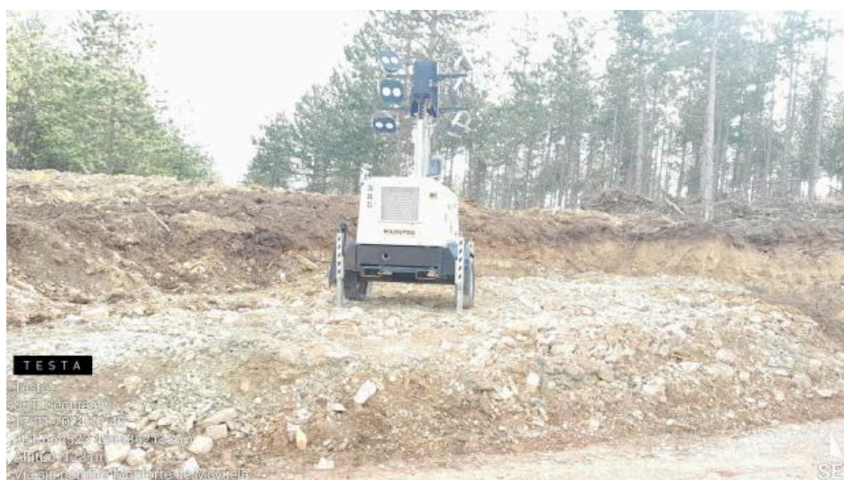
Generador sin protección de suelo en SE1-3
