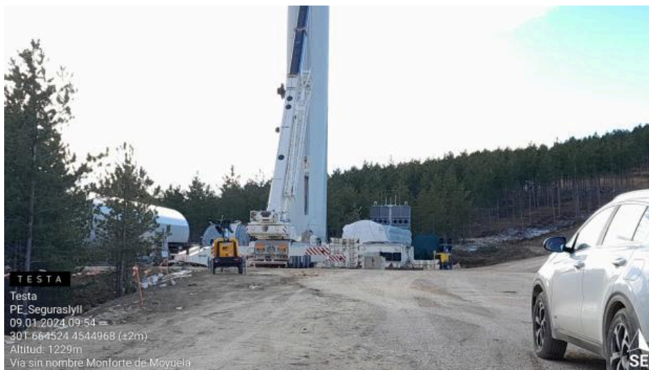
Generadores sin protección en SE1-3
