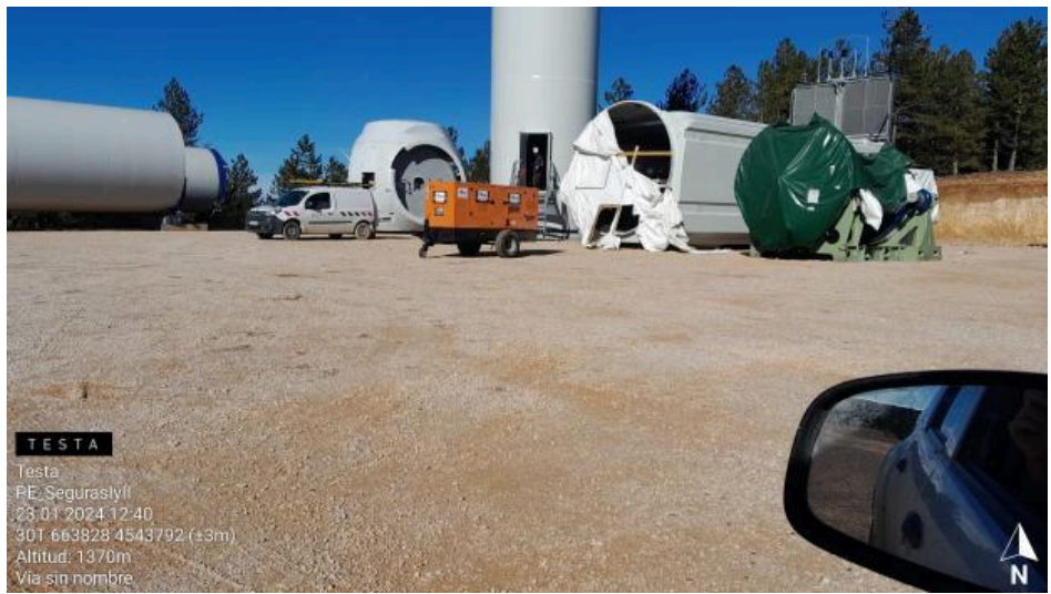
Generadores sin protección en SE1-1
