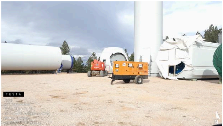
Generadores sin protección en SE1-1
