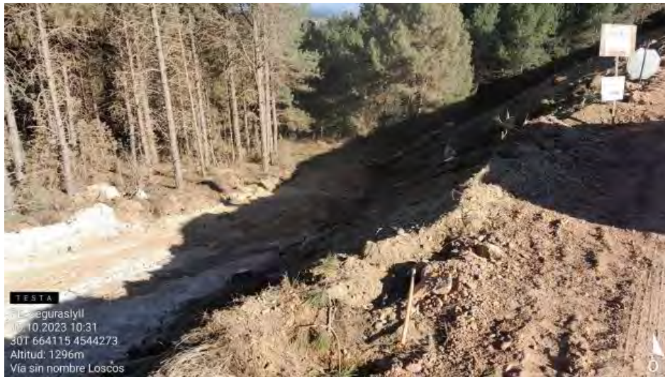
Conexión de camino vecinal en entrada a SE1-2
