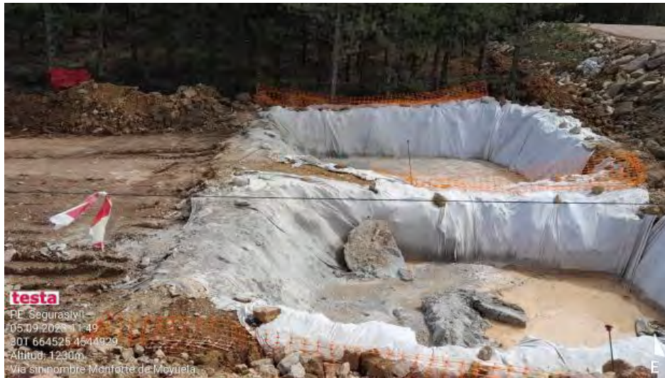
Pozos de lavado en SE1-3
