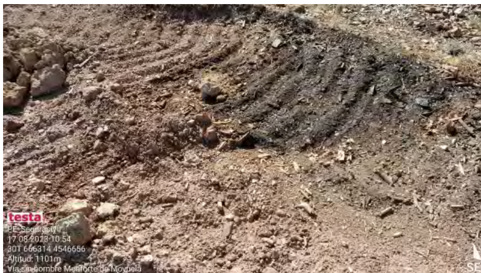
Mancha de líquido hidráulico localizada en lateral del vial principal en el acceso al parque .
