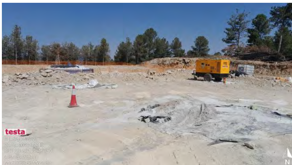
Restos de hormigón sin recoger en SE1-1
