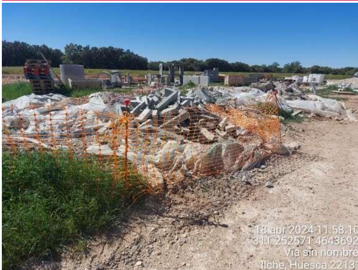
Imagen 1. Pozos de lavado en SET SC4 que se deben restaurar.
