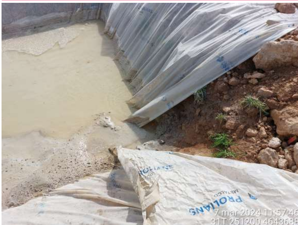
Imagen 1. NC leve debido a pozo de lavado utilizado sin impermeabilizar el suelo.
