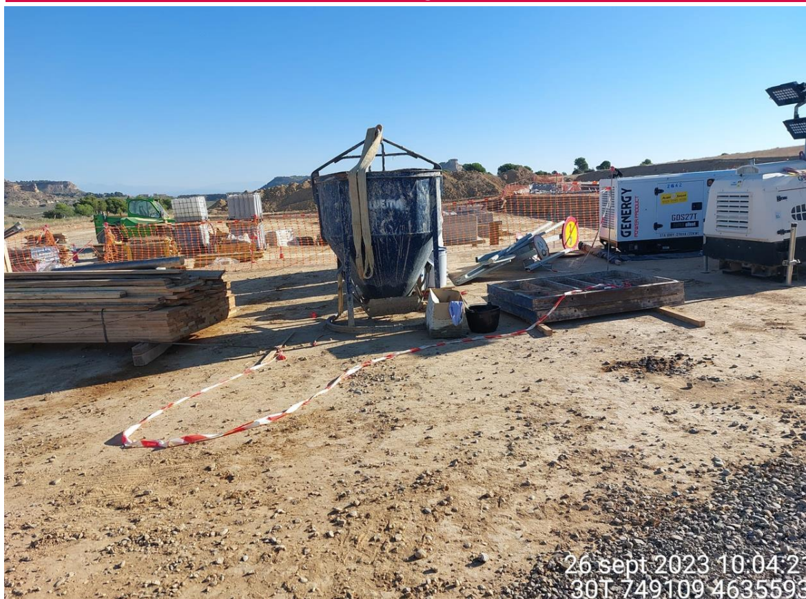
Imagen 1. Zona de la SET con hormigonera sin protección que solucionan cuando se notifica.
