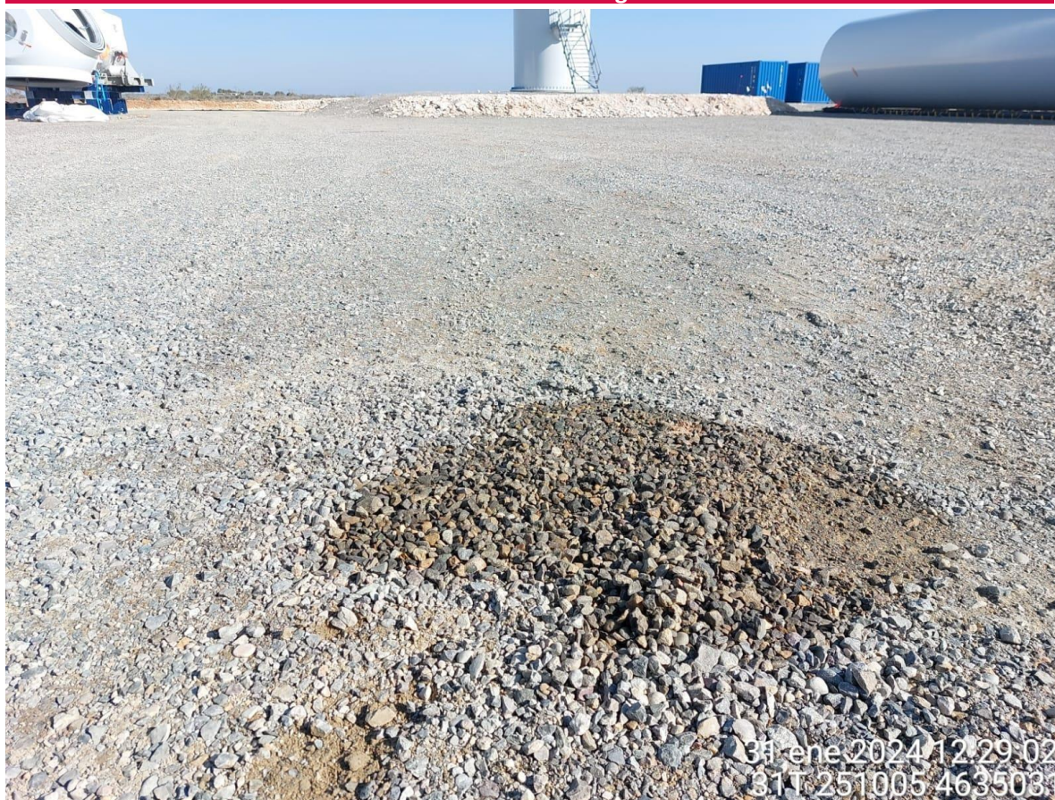
Imagen 1. No conformidad leve. Manchas por fugas de maquinaria en SC1.
