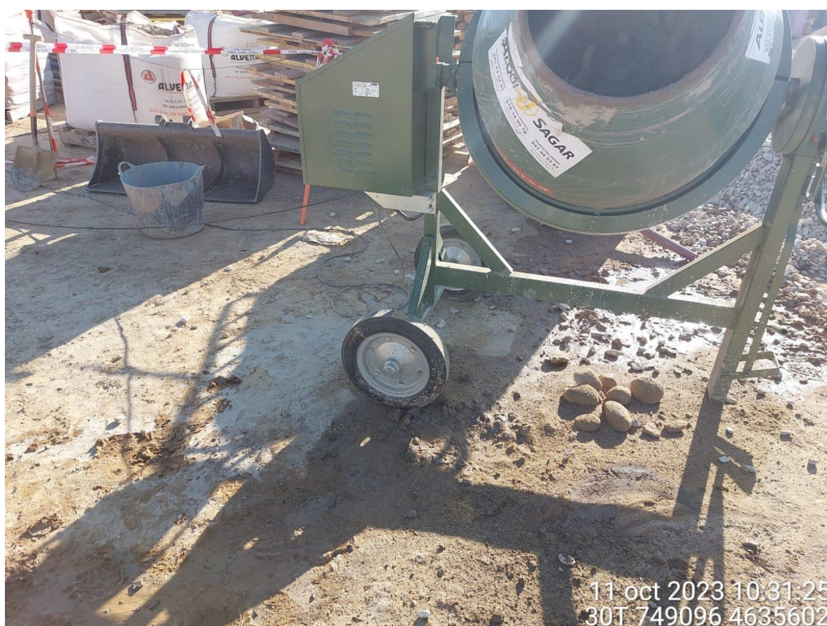
Imagen 2. No conformidad leve. Hormigonera trabajando sin protección del suelo, cayendo restos de cemento sobre él provocando su contaminación.
