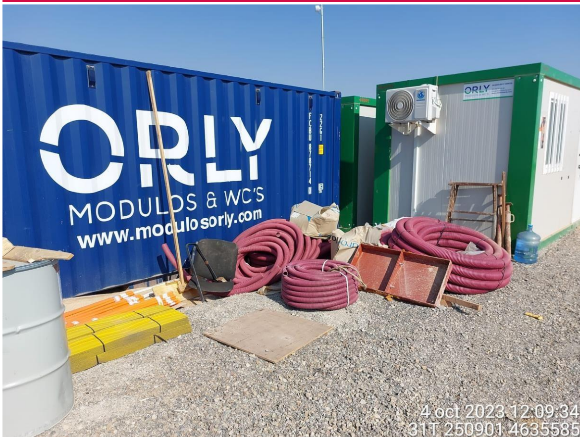
Imagen 2. Estado de la SET en la que hay que incidir en orden y limpieza.
