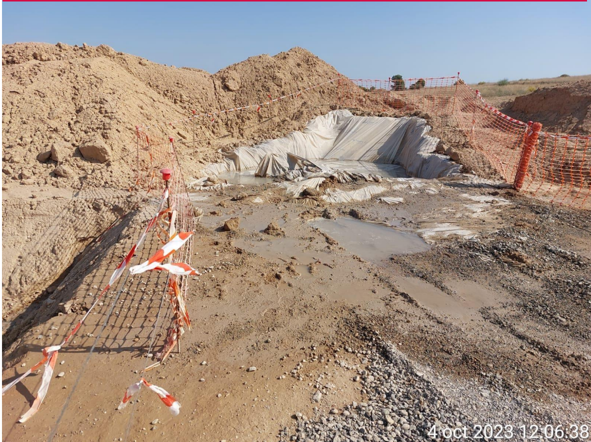
Imagen 1. No conformidad leve. Colmatación del pozo de lavado en SET.
