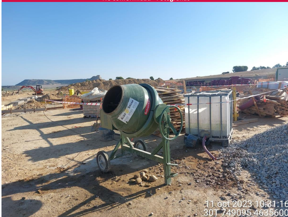
Imagen 1. No conformidad leve. Hormigonera trabajando sin protección del suelo, cayendo restos de cemento sobre él provocando su contaminación.
