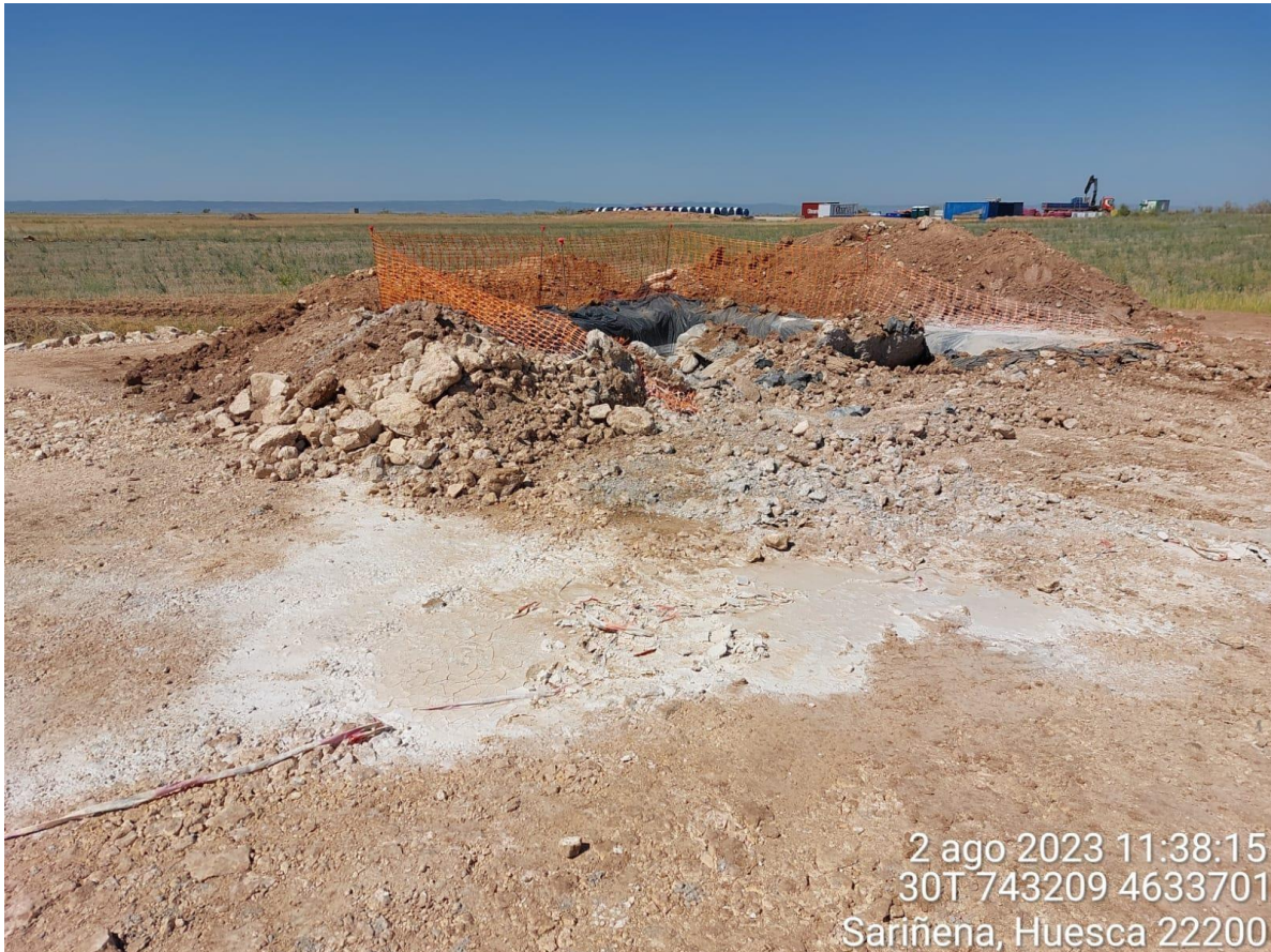
Imagen 1. Pozo de lavado con el suelo contaminado debido al lavado de las cubas.
