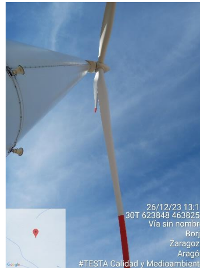
Fotografías 8 a 10: Barquillas de los aerogeneradores sin derrames de aceite. Pintado de palas.
