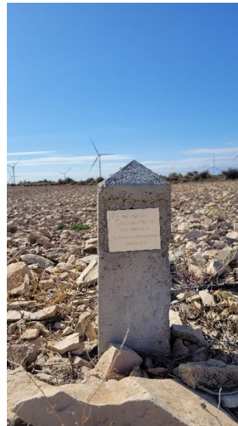
Fotografía 16: Señalización línea subterránea
