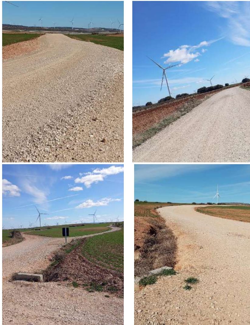
Fotografías 3 a 6: Estado de las redes de drenaje y viales.
