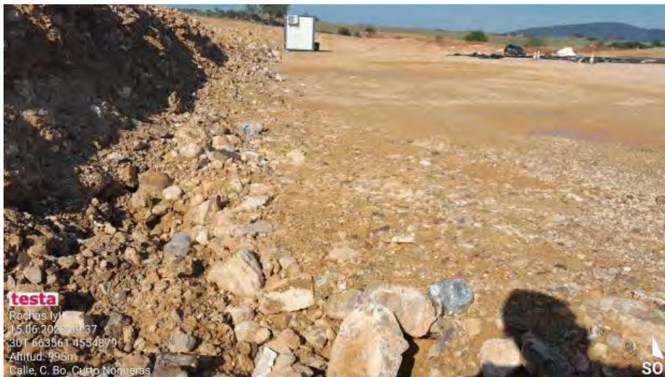
Residuos en plataforma.
