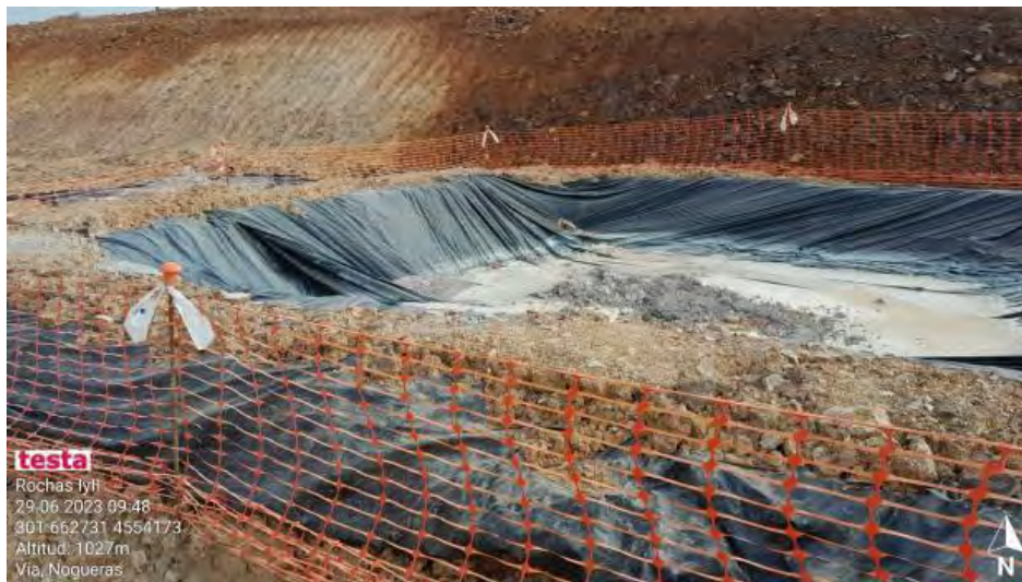
Nuevo pozo de lavado en correcto estado
