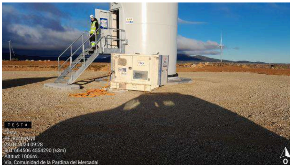
Generador sin protección en RH2-5
