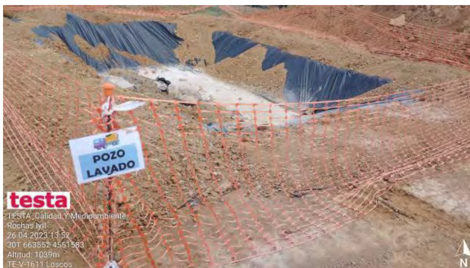
Pozo de lavado
