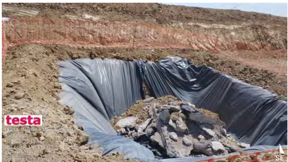
Pozo lavado sin corregir.
