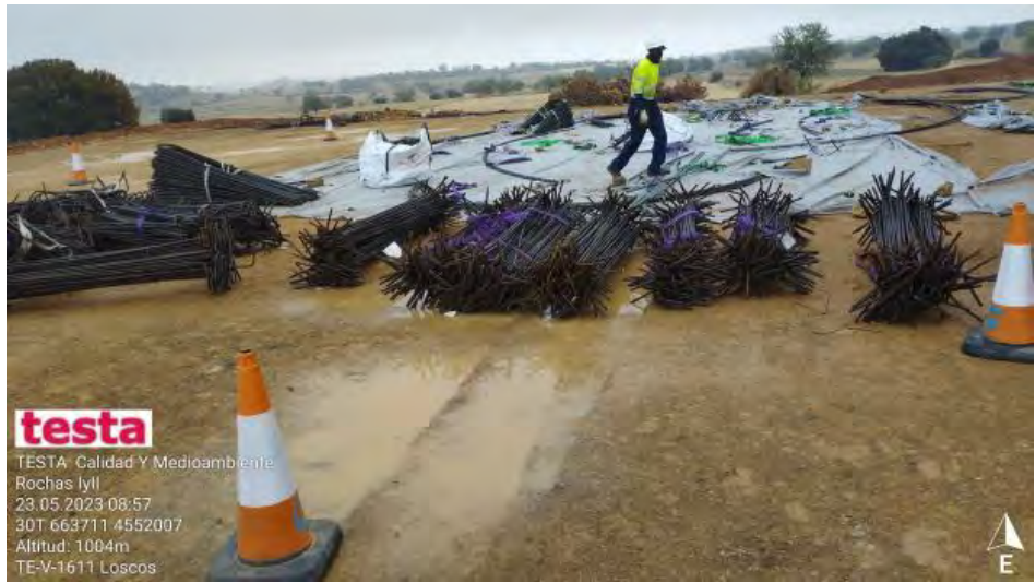
Ferralla sin protección en suelo y posibles contaminaciones por lluvia.
