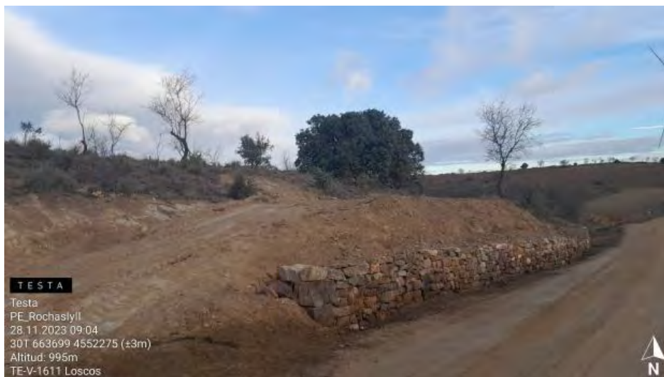
Restauración de murete en vial anterior a campa de acopio en RH2.
