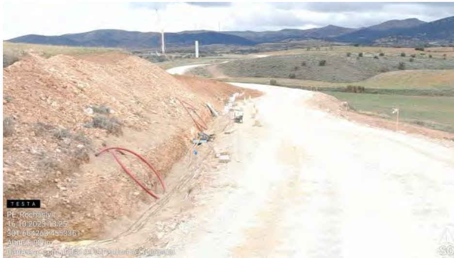
Generador sin protección de suelo
