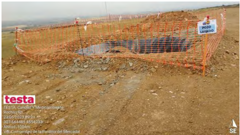
Limpiezas de hormigón deficientes.
