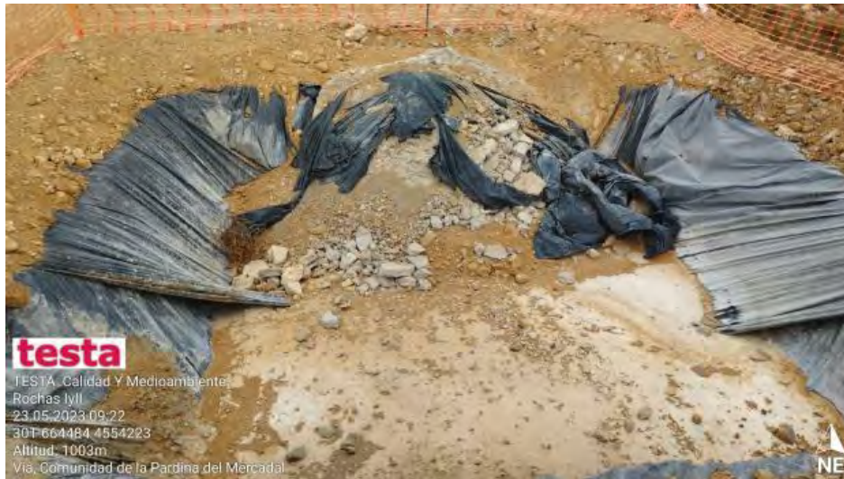
Pozo de lavado en mal estado.
