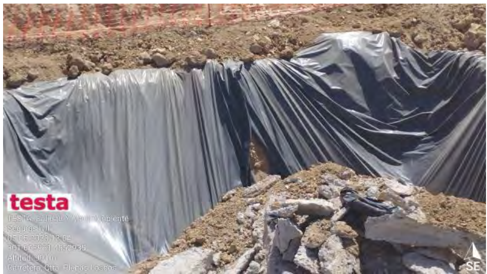
Pozo de lavado con rajas en la protección impermeabilizante.
