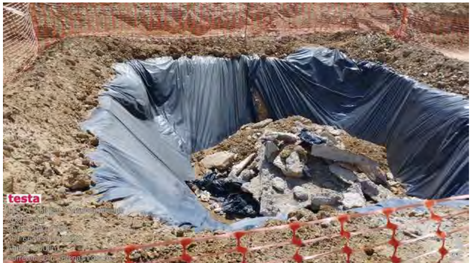
Pozo en mal estado y cerca del hormigonado de la zapata
