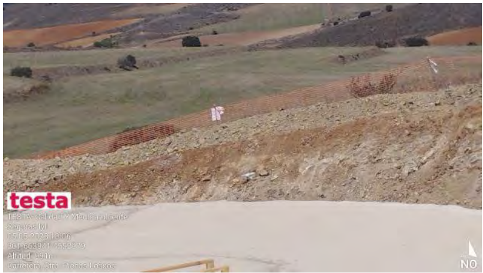
Restos de hormigón en talud.
