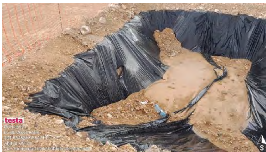
Pozo a la espera de reparar .
