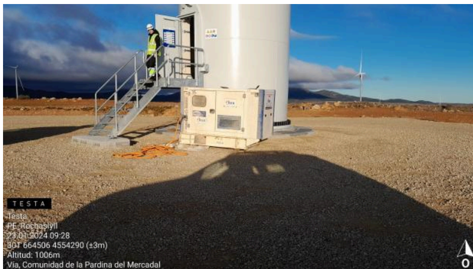
Generador sin protección en RH2-5
