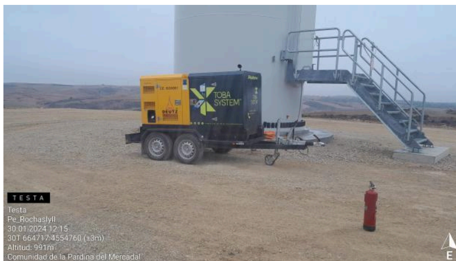
Generador sin protección de suelos en RH1-7
