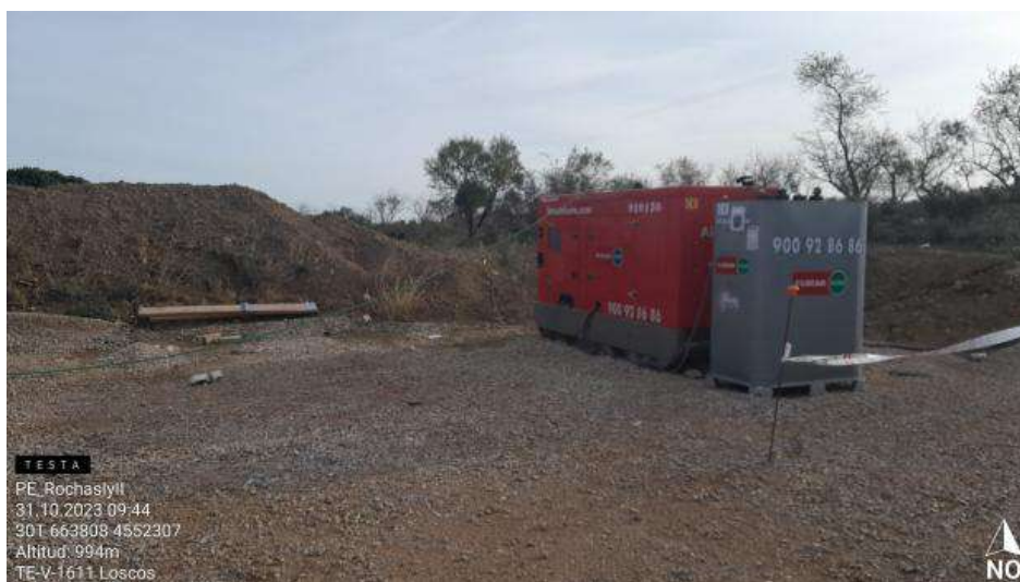
Generador sin protección de suelo
