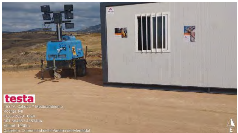
Generador sin bandejas y caseta sin elementos contra incendios
