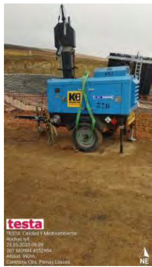
Generador sin bandejas y con fugas apreciables.
