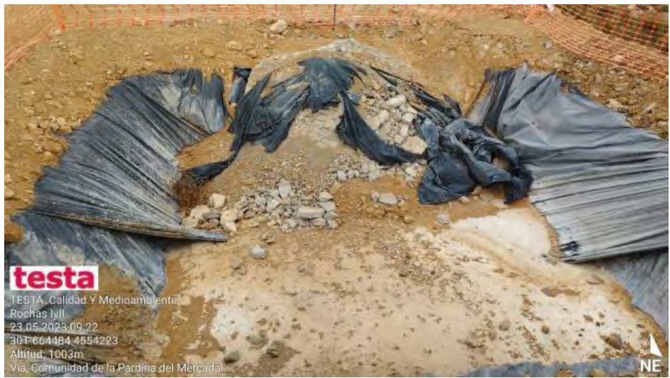
Pozo de lavado en mal estado.
