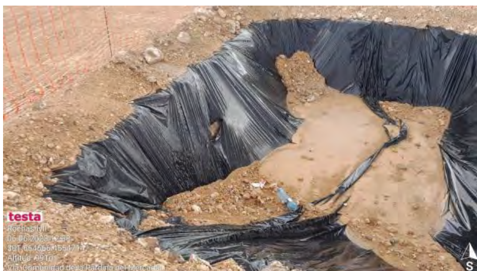
Pozo a la espera de reparar .
