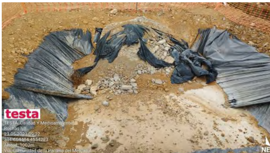
Pozo de lavado en mal estado.
