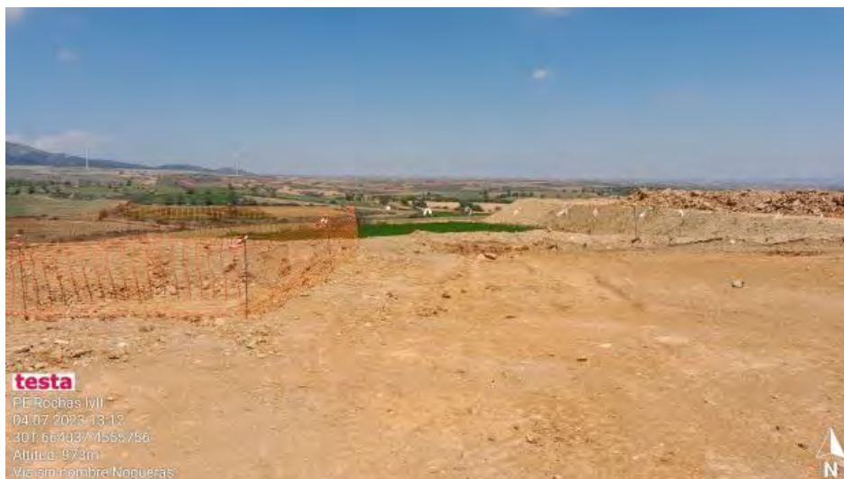
Limpieza de la zona en RH1-8 por NC de desbordamiento de pozo de lavado.
