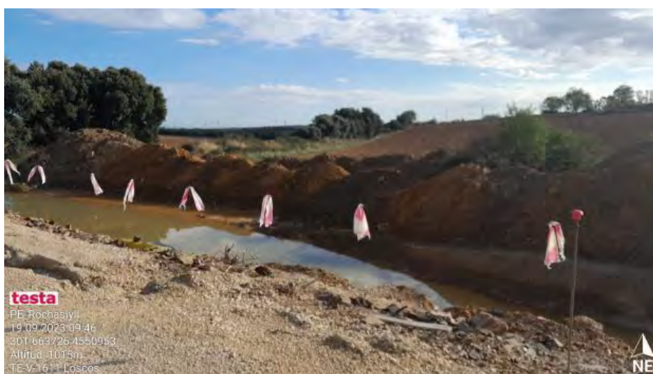
Acumulaciones de agua en la línea de evacuación tras las tormentas.
