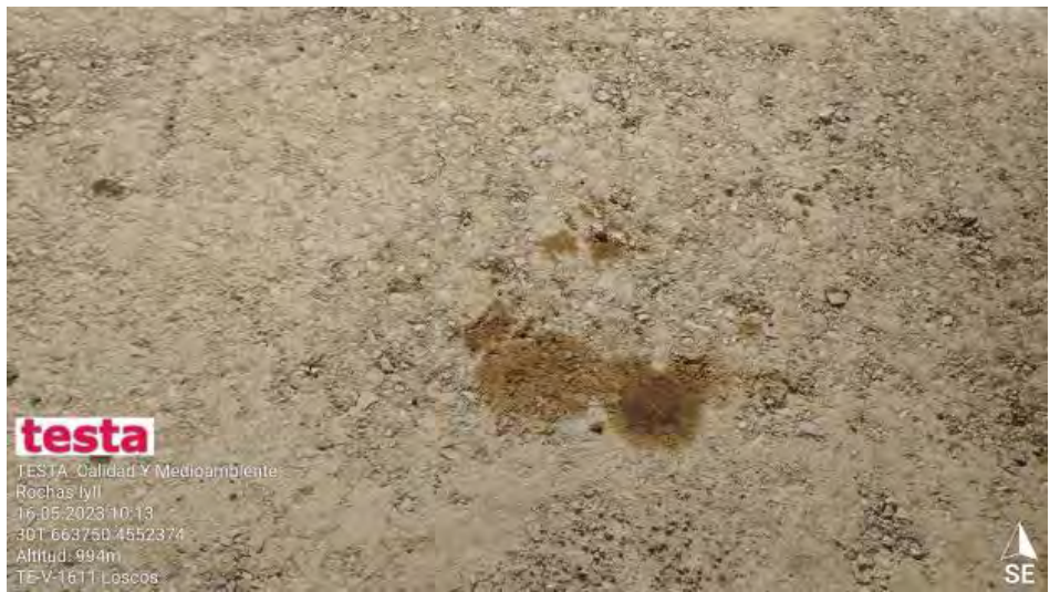
Derrame II en punto limpio
