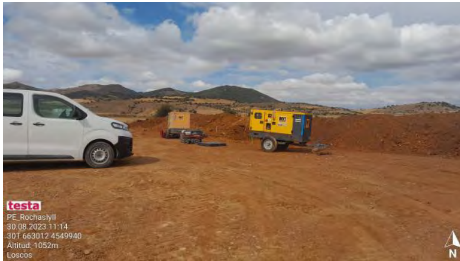
Generadores sin protección en RH1-1
