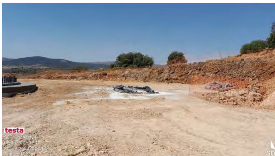
Residuo de grout sin gestionar en RH1-4
