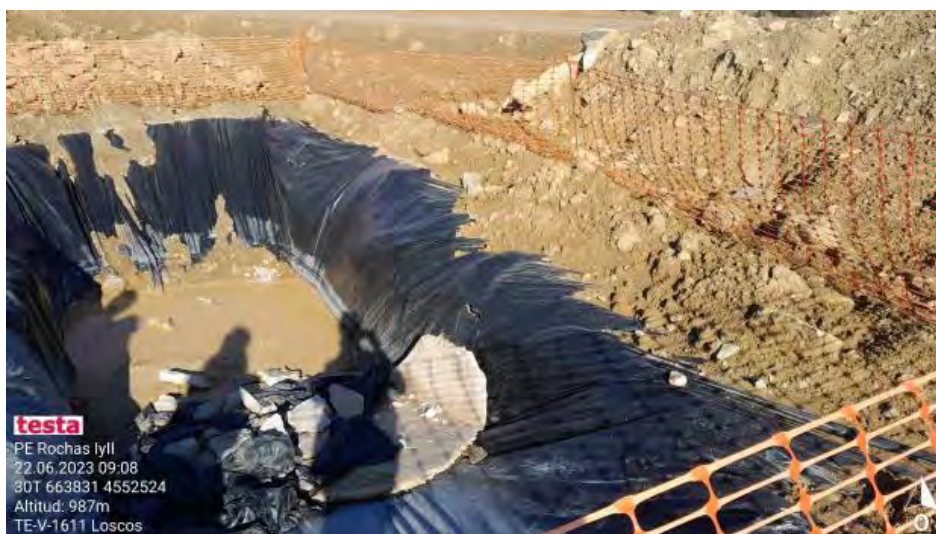
Pozo con defectos. Se indica que se repare.
