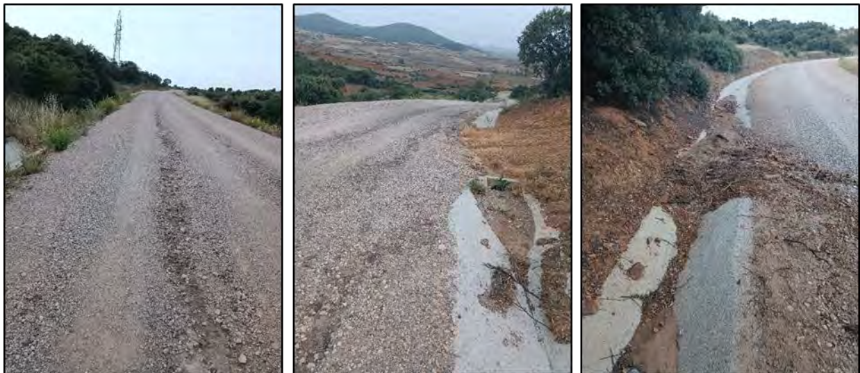
Fotografía 8. Proceso erosivo por escorrentía próximo al apoyo LPDH04
