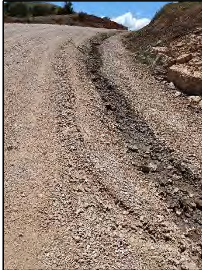
Fotografía 7. Proceso erosivo por escorrentía a la altura del acceso a la turbina PDH05
