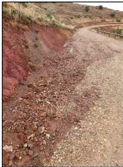
Fotografía 6. Pequeño derrumbe de la pendiente que ha producido la colmatación de la cuneta y regueros en el vial principal
