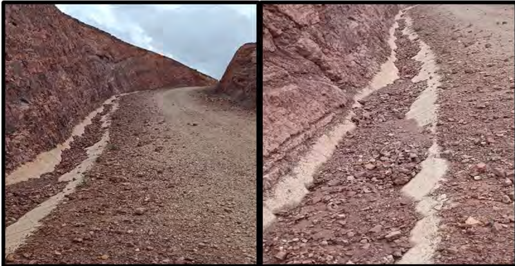
Fotografía 3. Derrumbamientos de material fino y pequeñas rocas asociados al vial de acceso a la turbina PDH01
