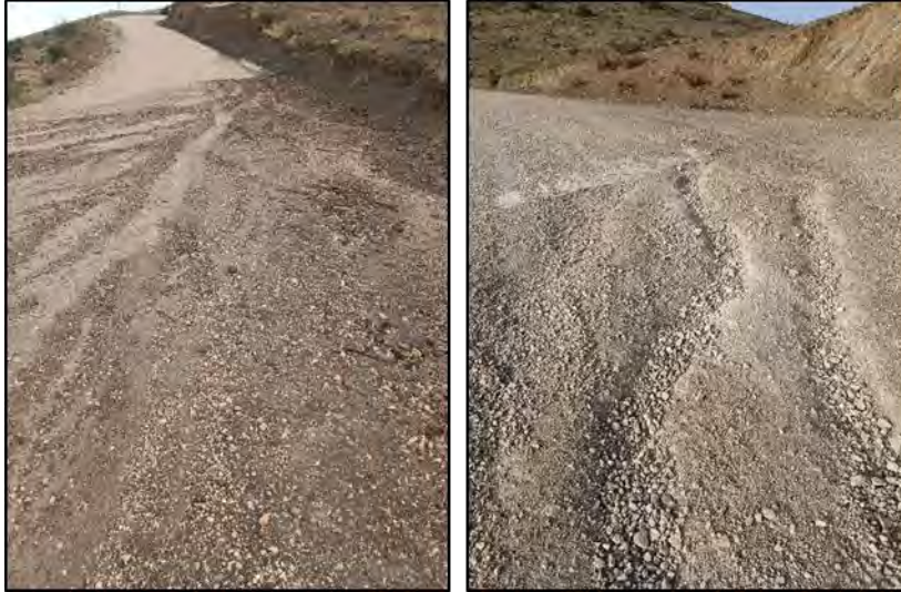
Fotografía 5. Proceso erosivo en el vial principal a la altura del acceso a la turbina PDH04
