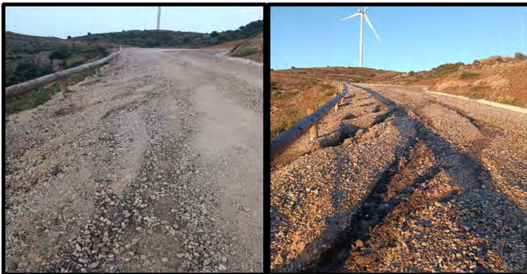
Fotografía 4. Evolución del proceso erosivo por escorrentía durante este cuatrimestre en el vial de acceso a PDH03
