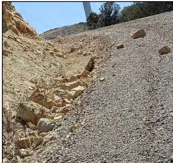
Fotografía 2. Derrumbamiento de rocas en el vial de acceso al aerogenerador PDH05.
