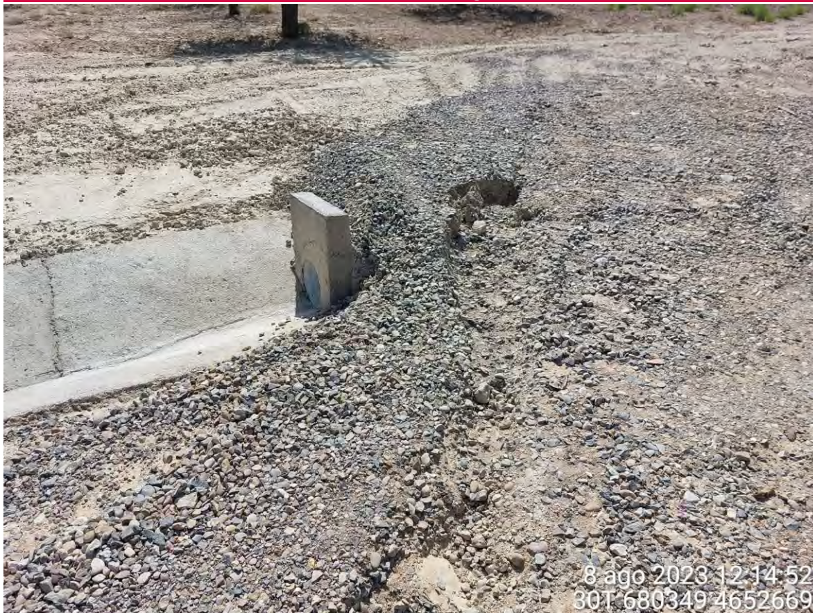
Imagen 1. Drenaje que se debe mejorar tras la restauración geomorfológica.
