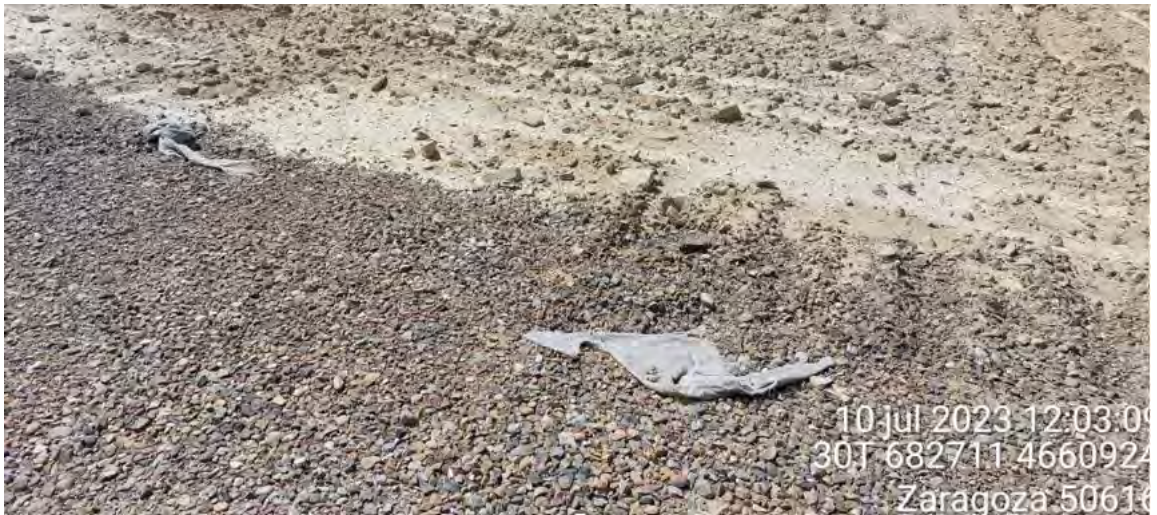
Imagen 2. Material geotextil en OBIII-02. Se debe retirar.
