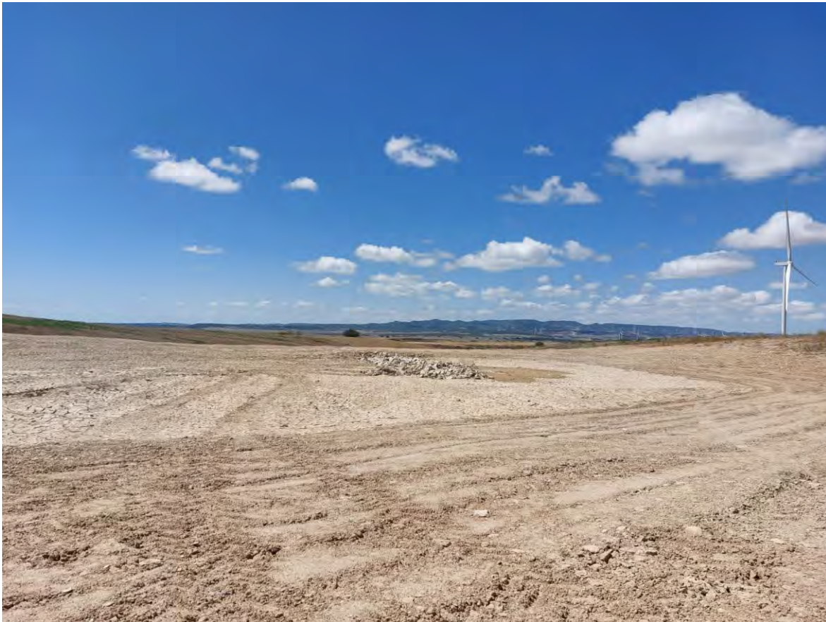
Imagen 1. Balsa cercana a OBIII-01 que en caso de lluvias se llena y se debe corregir.
