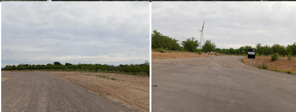
Fotografías 5 a 11: Estado de los caminos y viales
