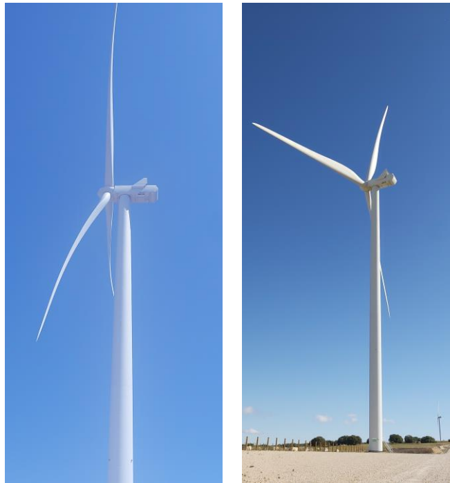
Fotografías 2 y 3: Barquillas de los aerogeneradores sin derrames de aceite
