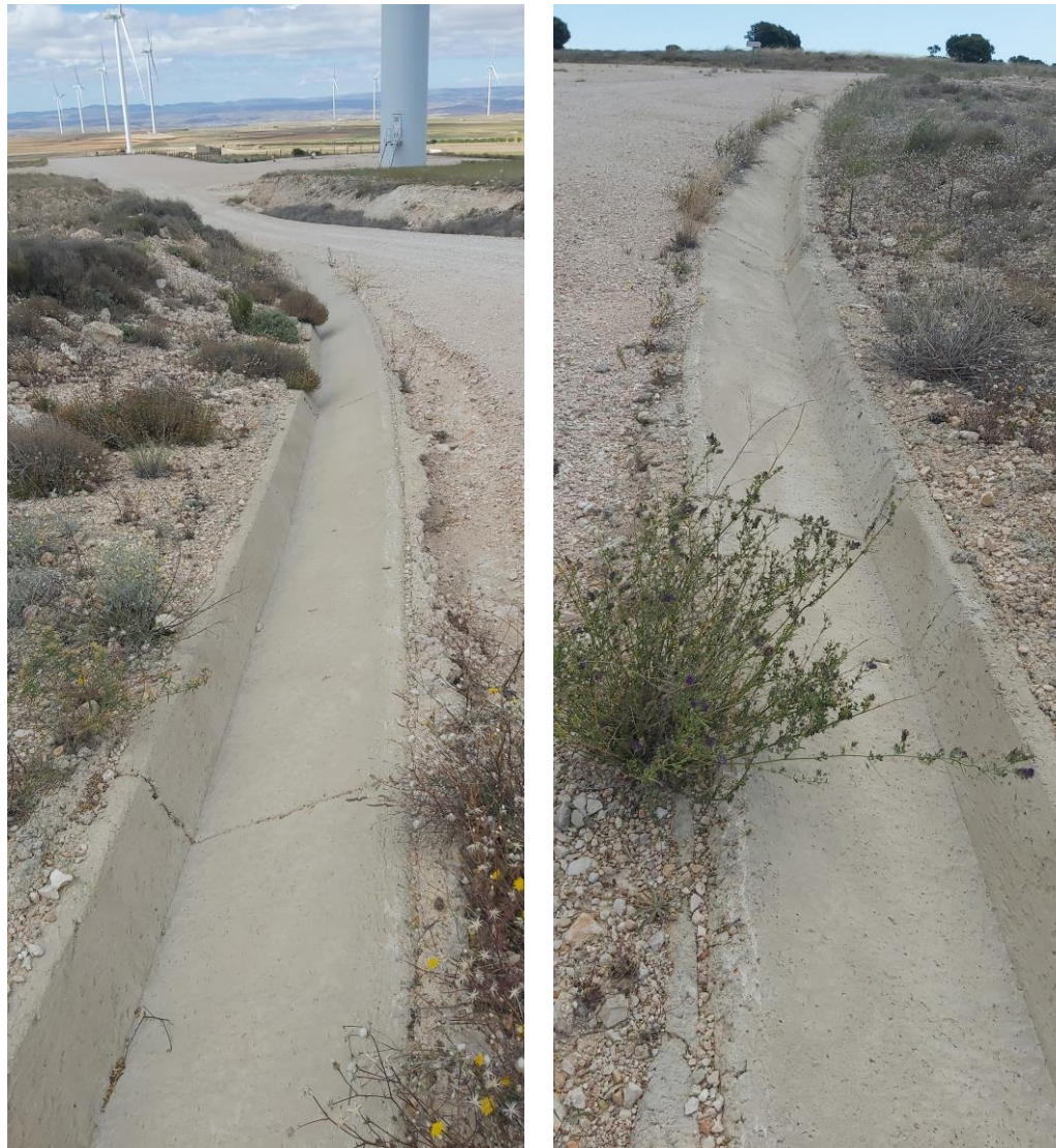
Fotografías 6 a 9: Señalización del parque y estado drenaje.
