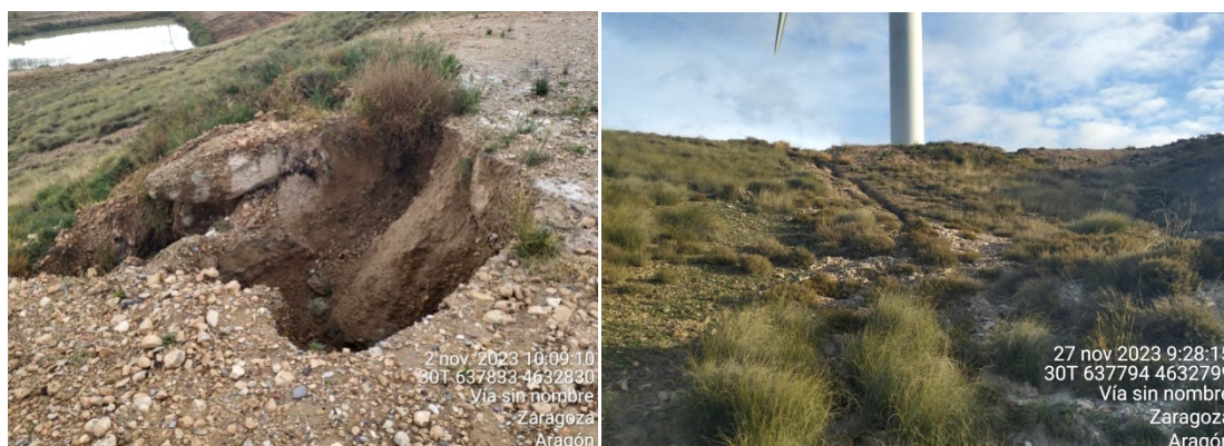
Figura 36: Fotografías de la erosión acusada del talud al sur de la plataforma del aerogenerador MU-09. El proceso erosivo había sido informado en anteriores informes cuatrimestrales y fichas de visita.
