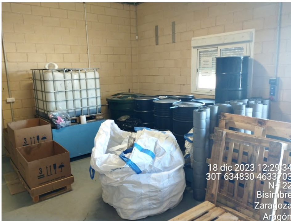
Figura 53: Interior del almacén de residuos de la SET “Valcardera”, con los diferentes residuos peligrosos aislados de la intemperie y sobre una tarima aislante para evitar posibles filtraciones al suelo.
