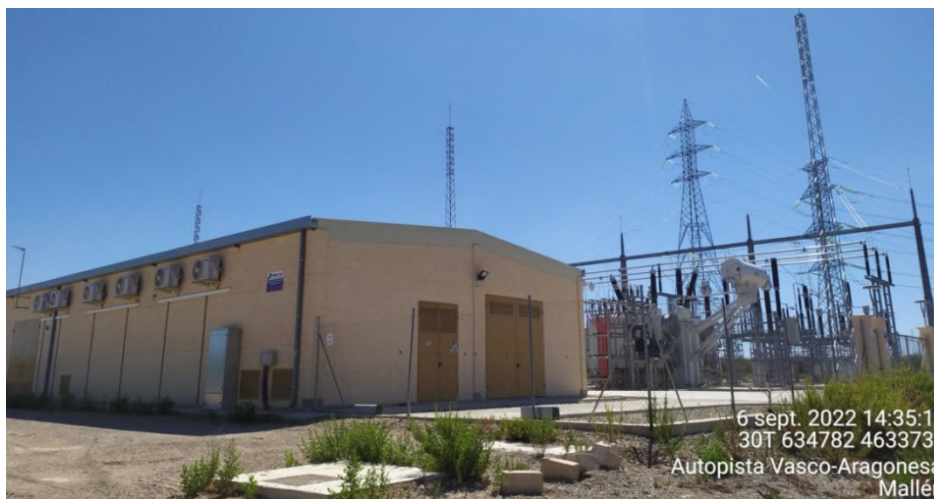
Figura 52: Subestación eléctrica Valcardera, SET asociada a PE “Agón” en la que se realiza la gestión de residuos del PE, así como la ubicación del arcón refrigerador para la conservación de siniestros asociados al PE.
