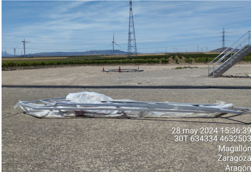
Brida metálica y piezas sobrantes de la escalera de la base del aerogenerador, pendientes de su retirada de obra.
