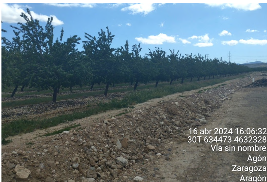
Tramo soterrado de cable de evacuación, paralelo al vial en su tramo central. Obsérvese que el montículo de tierra paralelo al tramo soterrado es el resultado de un nivelado del campo de cultivo arbóreo aleadaño realizado en pasados meses a petición del propietario del mismo.
