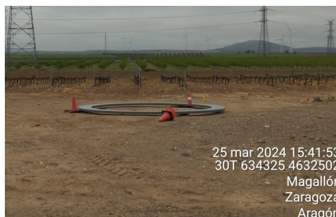
Brida metálica sobrante de la base del aerogenerador, pendiente de su retirada de obra.
