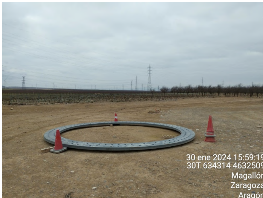
Brida metálica sobrante de la base del aerogenerador, pendiente de su retirada de obra.
