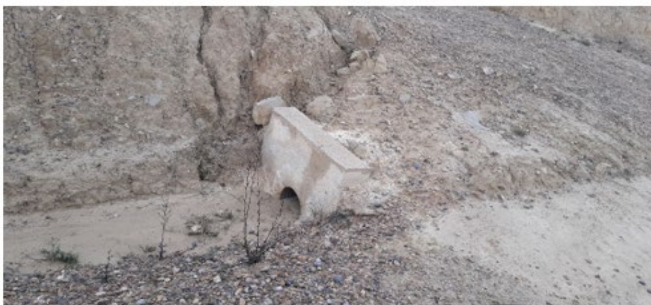
Tubo de drenaje semitaponado por sedimentos en vial de acceso al aero ML5.09.
