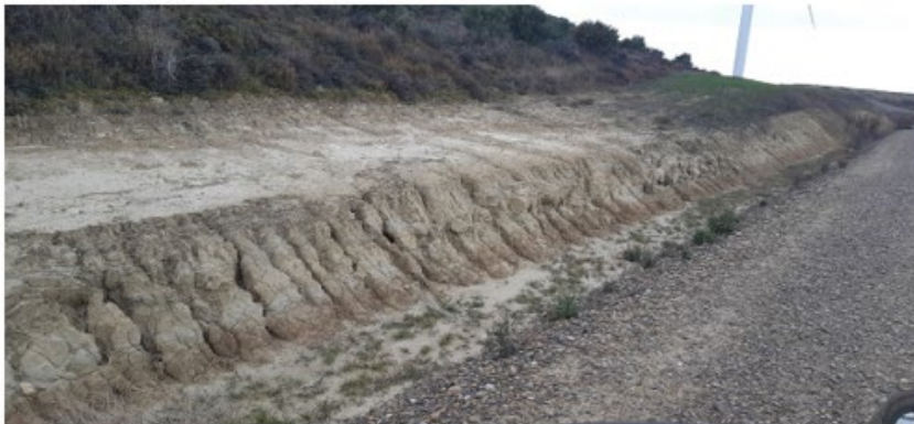
Erosión hídrica en materiales margosos del talud de desmonte del vial de acceso al aero ML5.09
