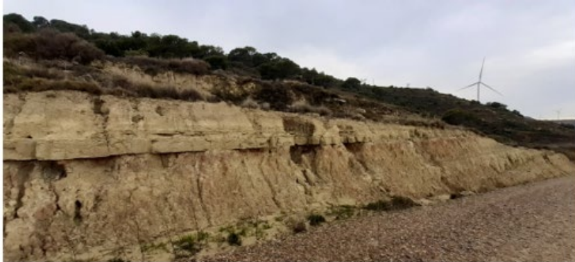
Erosión hídrica en materiales margosos del talud de desmonte del vial de acceso al aero ML5.05
