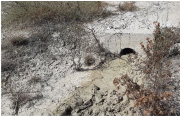
Fig. 7 Tubo de drenaje semitaponado con sedimentos en vial de acceso al aero ML4.02. Fuente: Elaboración propia
