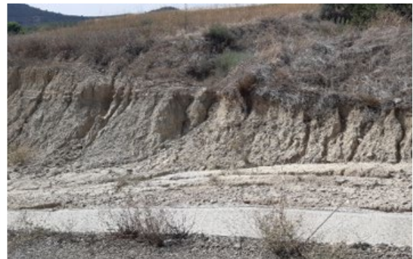
Fig. 2 Erosión hídrica en materiales margo-lutíticos del talud de desmonte del vial de acceso al aero ML4.02. Fuente: Elaboración propia
