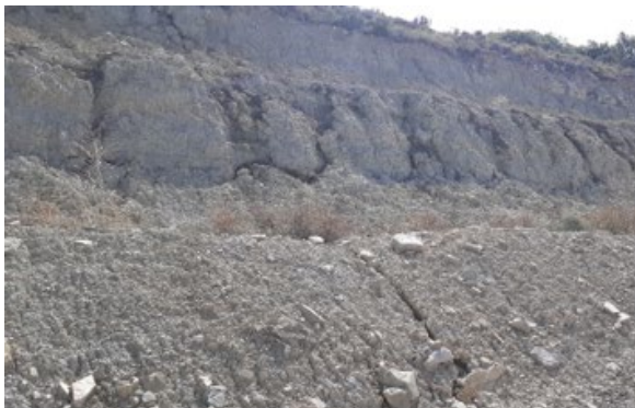
Fig. 1 Erosión hídrica en materiales margosos del talud de desmonte del vial de acceso al PE ML4. Fuente: Elaboración propia
