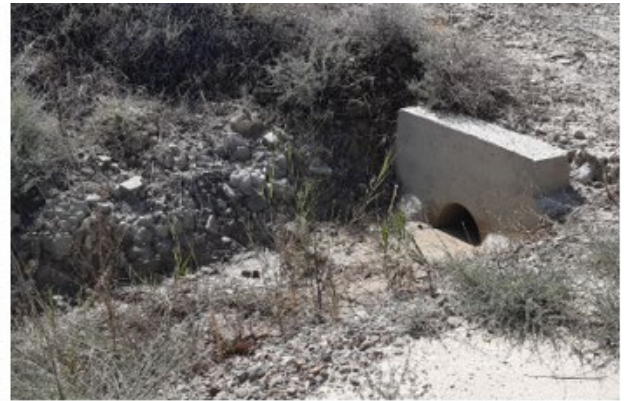
Fig. 8 Tubo de drenaje taponado por vegetación arbustiva y sedimentos en vial de acceso al aero ML4.05. Fuente: Elaboración propia
