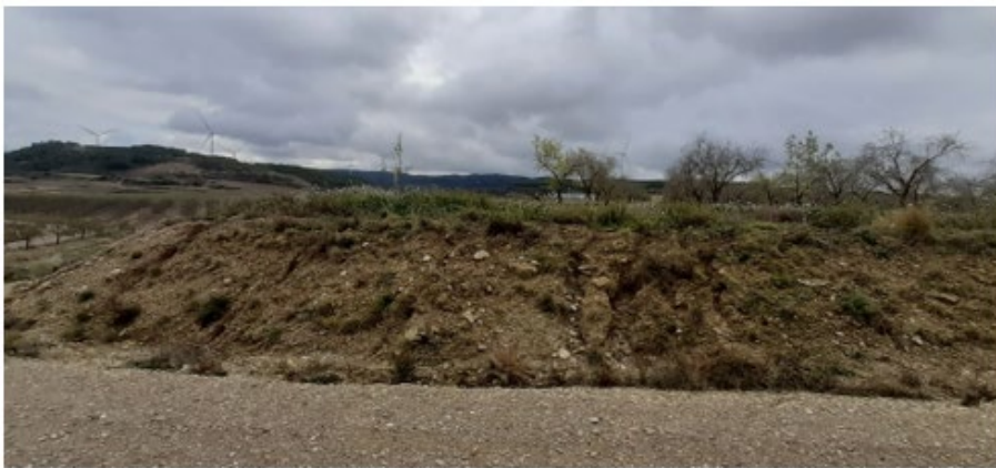
Erosión hídrica en materiales margosos del talud de desmonte del vial de acceso al aero ML3.04.
