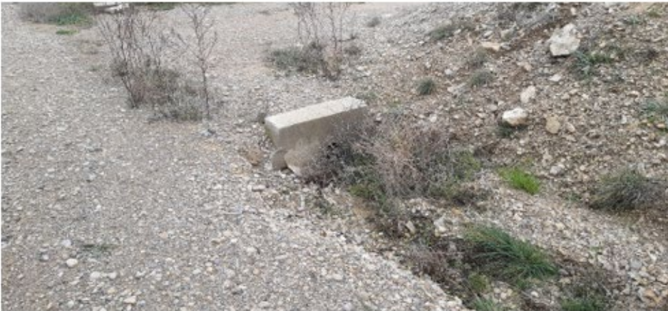
Tubo de drenaje taponado con vegetación arbustiva y sedimentos en vial de acceso al aereo ML3.04.
