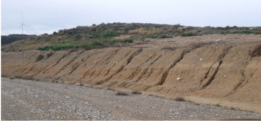
Erosión hídrica en materiales margo-lutíticos del talud de desmonte del vial de acceso al PE ML3.
