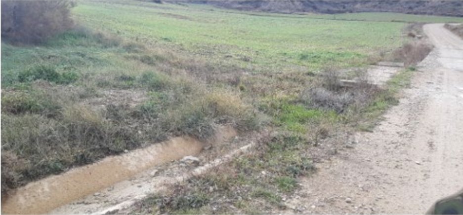
Tubo de drenaje taponado por vegetación arbustiva y sedimentos en vial de acceso al PE ML3. Cuneta llena de sedimentos.
