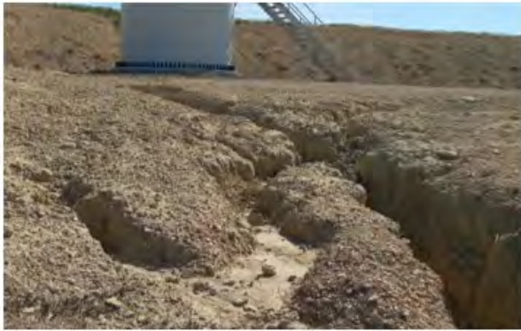
Fig. 1 Erosión hídrica en materiales margo-arenosos del talud terraplén de la cimentación del aro ML3.09. Fuente: Elaboración propia
