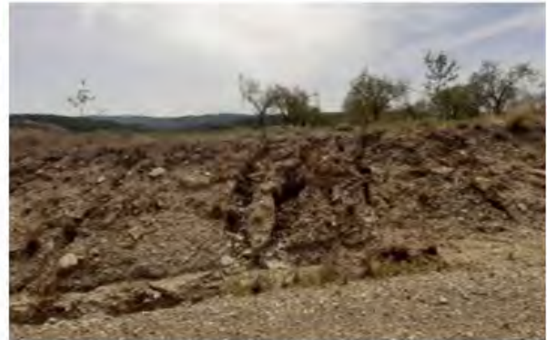
Fig. 2 Erosión hídrica en materiales margosos del talud de desmorte del vial de acceso al aro ML3.04. Fuente: Elaboración propia
