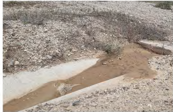
Fig. 3 Tubo de drenaje taponado con sedimentos en vial de acceso al aero ML3.14. Fuente: Elaboración propia
