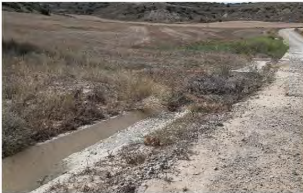
Fig. 2 Tubo de drenaje taponado por vegetación arbustiva y sedimentos en vial de acceso al PE ML3. Cuneta llena de sedimentos. Elab. propia
