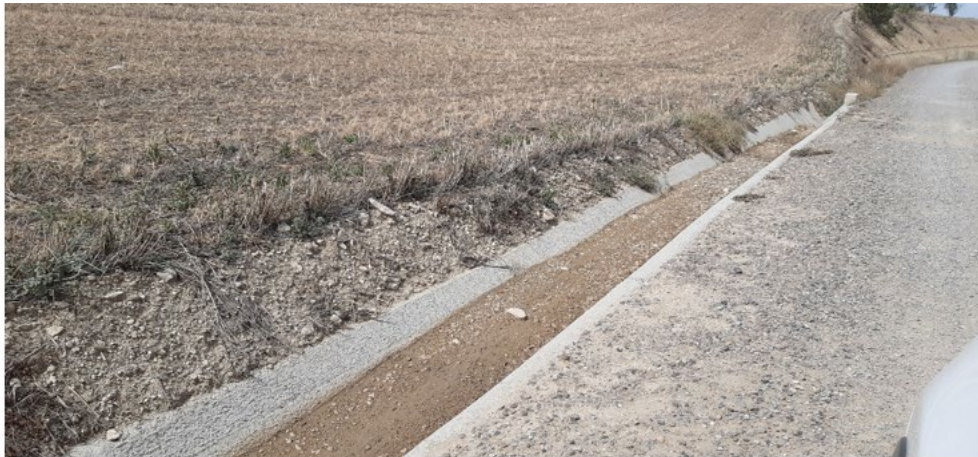
Cuneta llena de sedimentos en vial de acceso al aereo ML2.15.
