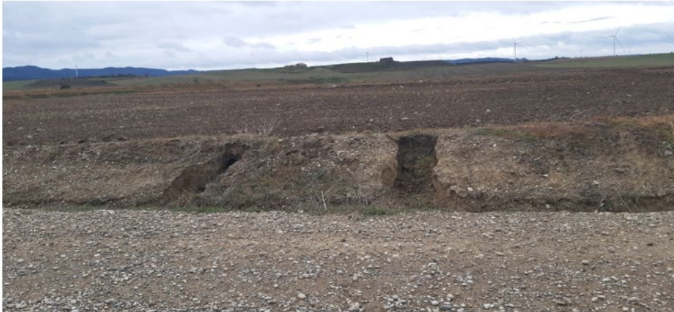
Erosión hídrica en materiales margo-lutíticos del talud de desmonte del vial de acceso al aero ML2.08
