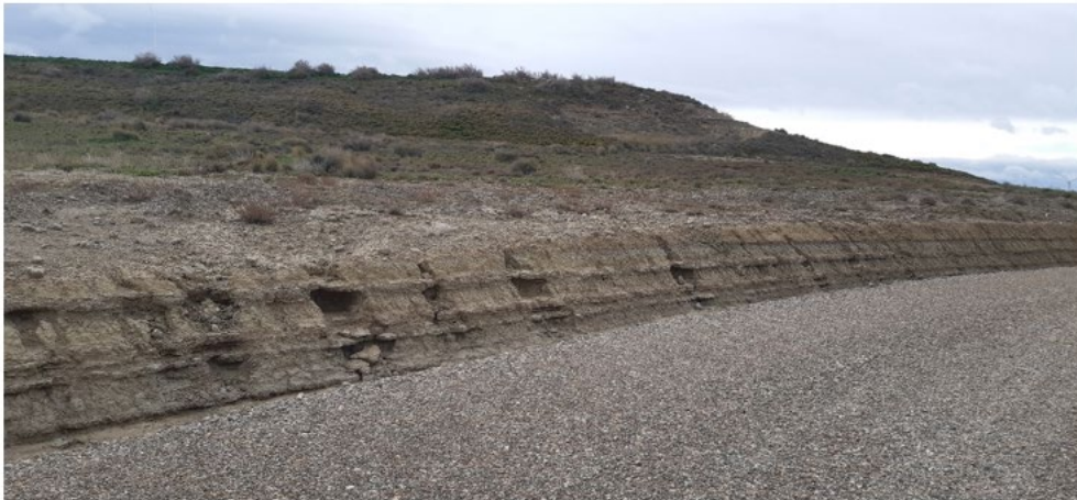
Erosión hídrica en materiales margosos del talud de desmonte del vial de acceso al aero ML2.09
