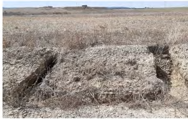
Fig. 4 Erosión hídrica en materiales margo-lutíticos del talud de desmonte del vial de acceso al aereo ML2.08. Fuente: Elaboración propia
