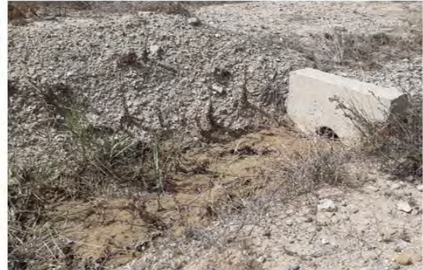
Fig. 4 Tubo de drenaje semitaponado con sedimentos en vial de acceso al aereo ML2.08.
