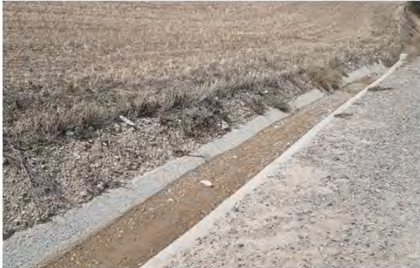
Fig. 3 Cuneta llena de sedimentos en vial de acceso al aereo ML2.15.
