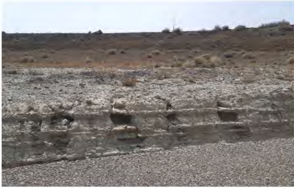
Fig. 3 Erosión hídrica en materiales margosos del talud de desmonte del vial de acceso al aereo ML2.09. Fuente: Elaboración propia
