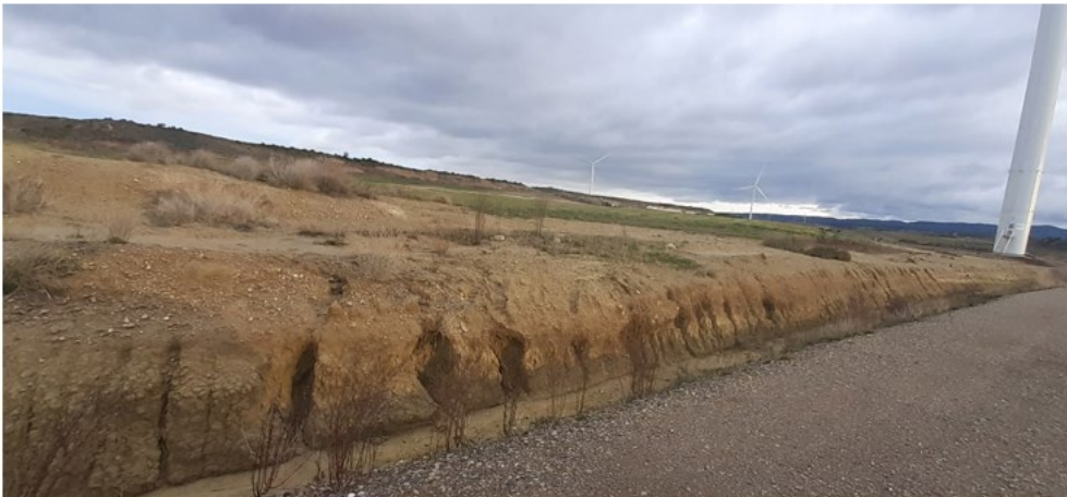
Erosión hídrica en materiales margosos del talud de desmonte del vial de acceso al aero ML1.01
