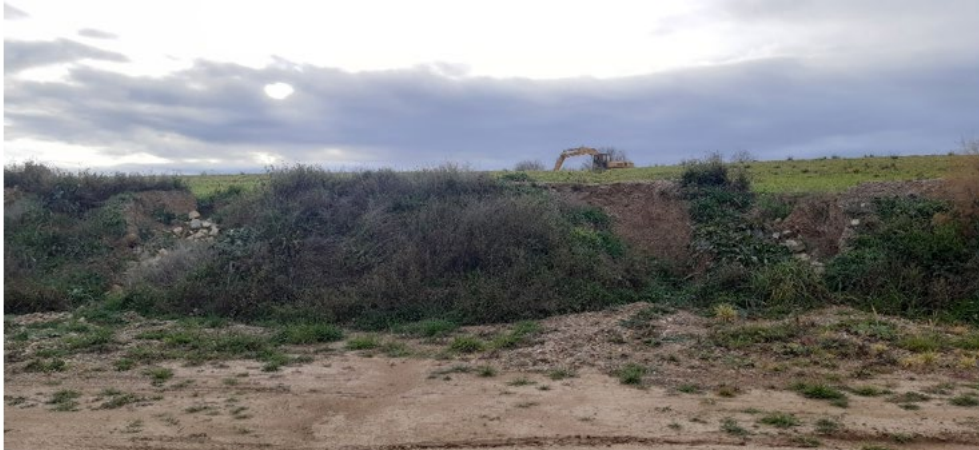
Erosión hídrica en materiales margo-lutíticos del talud de desmonte de plataforma del aero ML1.15
