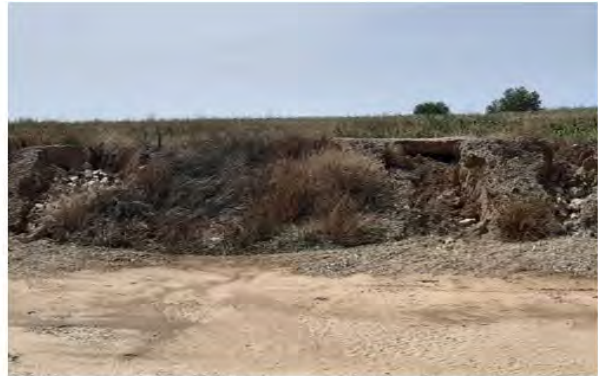
Fig. 2 Erosión hídrica en materiales margo-lutíticos del talud de desmonte de plataforma del aero ML1.15. Fuente: Elaboración propia.
