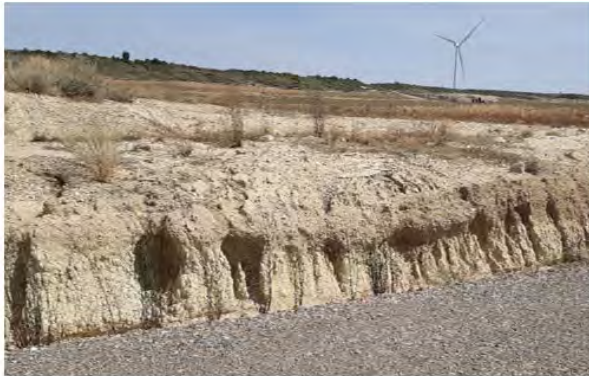
Fig. 1 Erosión hídrica en materiales margosos del talud de desmonte del vial de acceso al aero ML1.01. Fuente: Elaboración propia.
