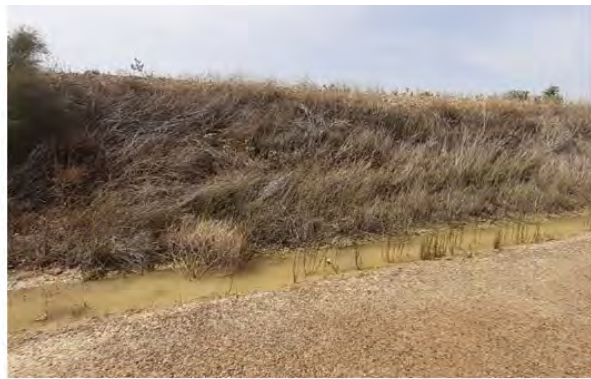
Fig. 3 Encharcamiento en margen de plataforma del aero ML1.15. Fuente: Elaboración propia
