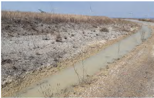
Fig. 2 Encharcamiento en margen de vial de acceso al aero ML1.12. Fuente: Elaboración propia
