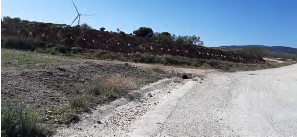
Fig 1. Cuneta llena de sedimentos en vial acceso al PE MO1.
