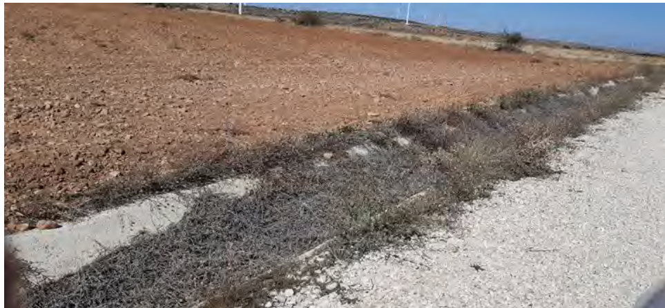
Fig 2. Cuneta llena de vegetación arbustiva en vial de acceso al aero MO1-10.
